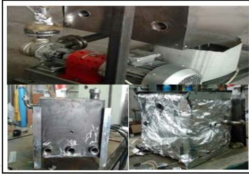
Şekil 2. 3.Kızgın yağ tankı ve yağ pompası
