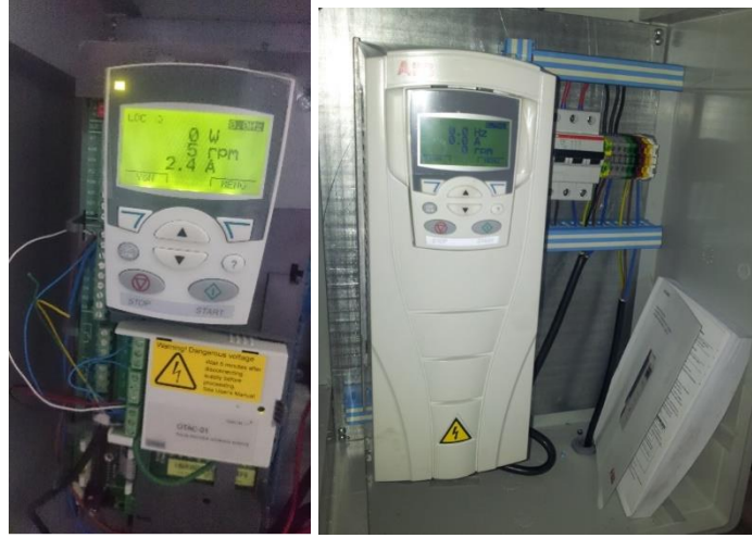
Şekil 3.19. Pompa motor sürücüsü.
