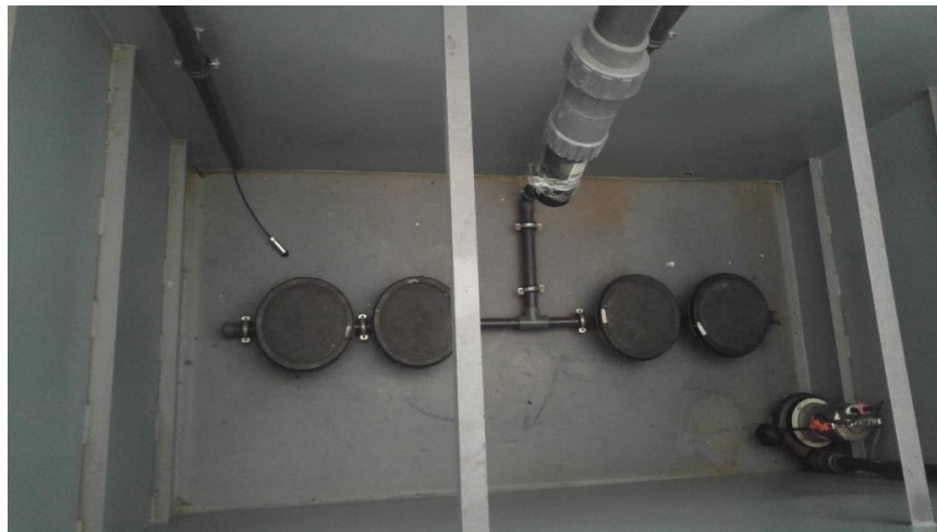
Şekil 2.3. Aerobik tank fotoğrafı
