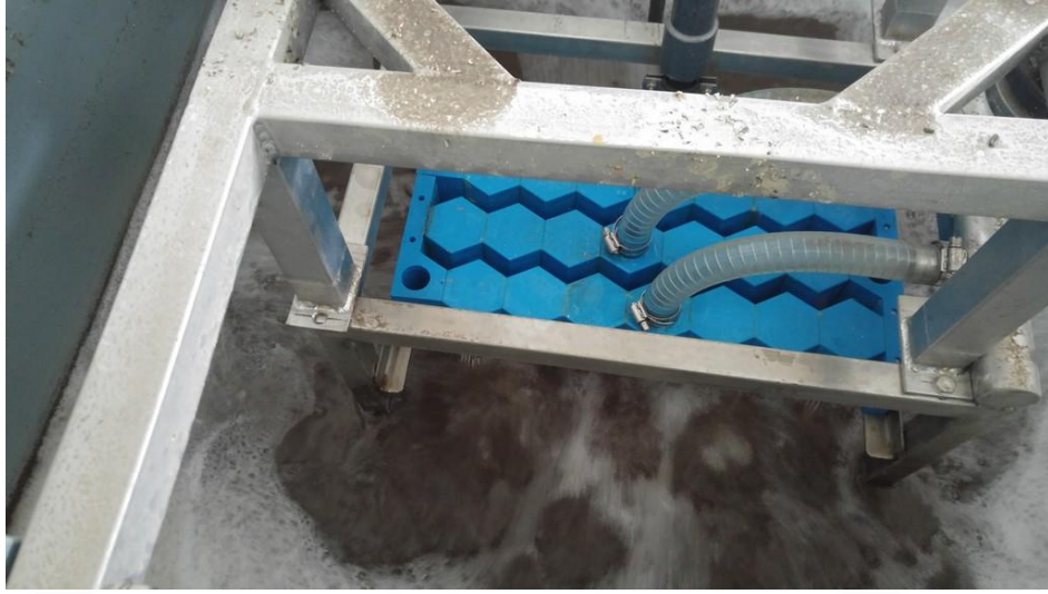
Şekil 2.5. Membran modülünün MBR tankındaki görüntüsü
