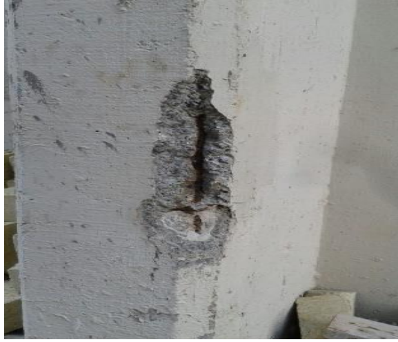
Şekil 4.1 : Kolon donatılarında korozyon.
