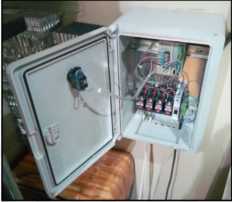
Şekil 3.18. Termal Çevrim sisteminde 2 farklı selonoid valfin kontrolünü sağlayan PLC ünitesinin gösterimi
