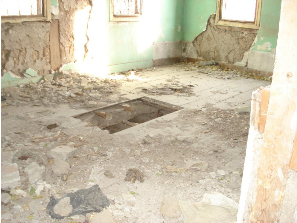
Resim 4.108. 110 mekânının döşemesindeki hasar, Temmuz 2011 [31]
