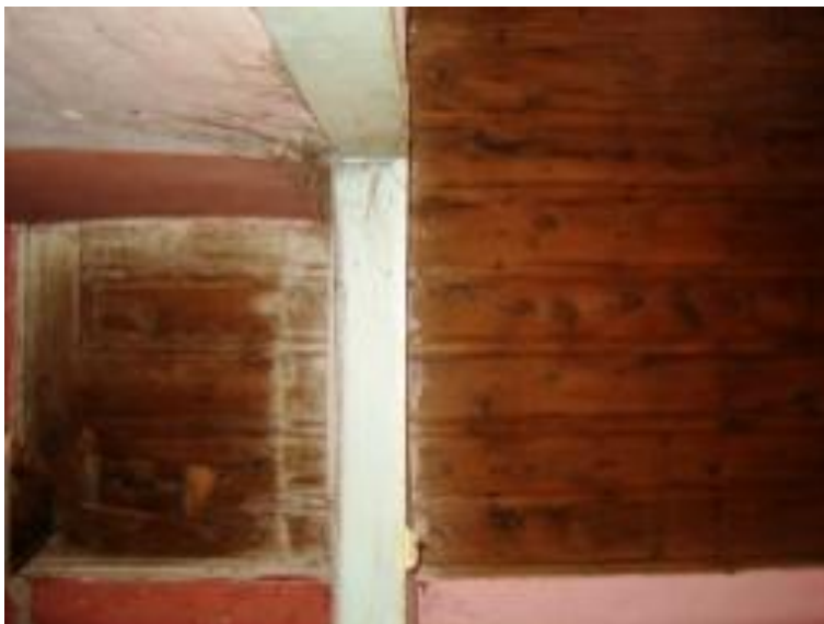
Resim 4.56. Z02 mekânında yüklük olarak sonradan ayrılan bölüm ile Z02 mekânın tavanı, Temmuz 2011 [31]
