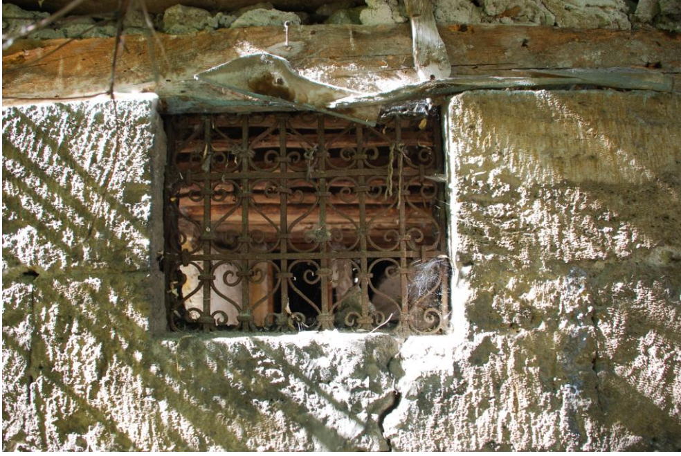
Resim 4.27. Güney cephesindeki PB5 penceresi, Temmuz 2011 [31]
