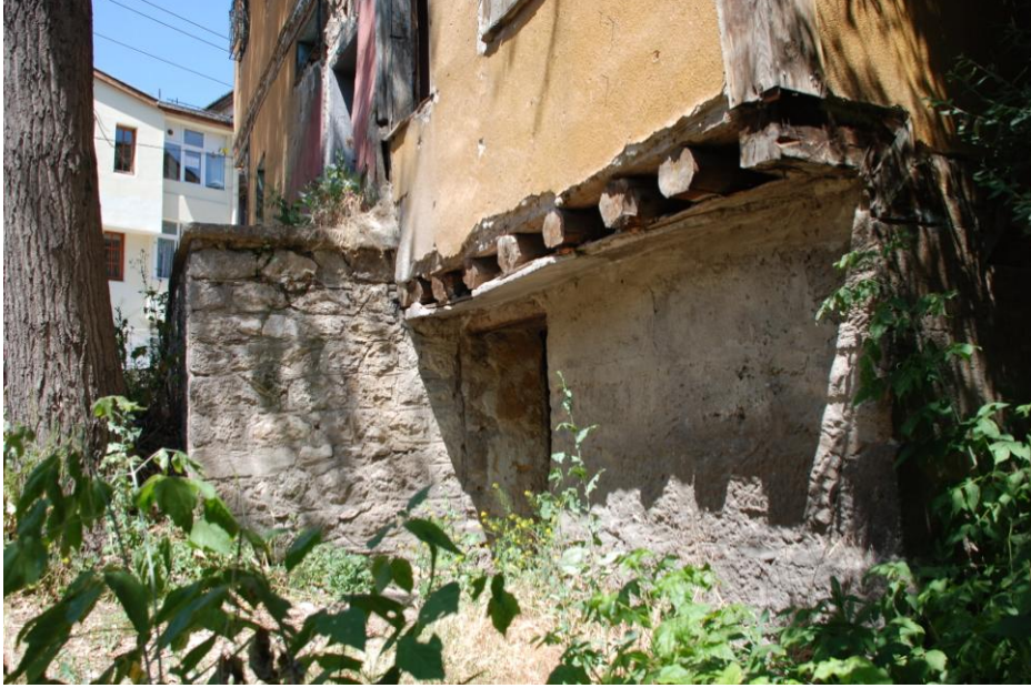
Resim 4.19. Batı cephesi zemin kattaki çıkma ve açıkta kalan ahşap kirişlemeler, Temmuz 2011 [31]
