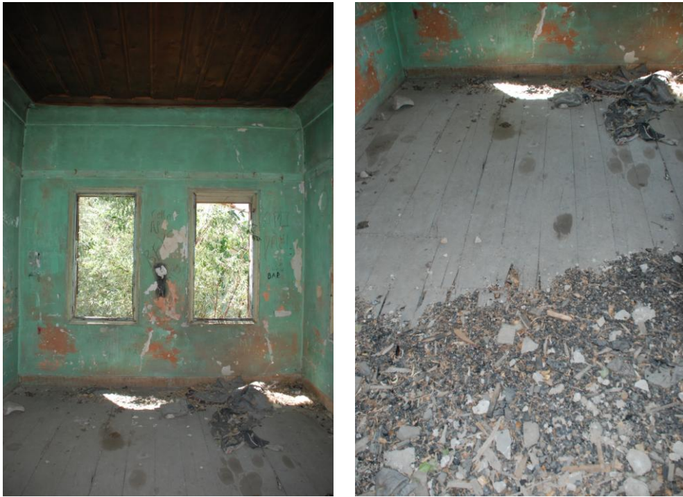
Resim 4.81.-4.82. 101 mekânı D3 duvarı üzerindeki pencereler ve hasarlı döşeme kaplaması, Temmuz 2011 [31]
