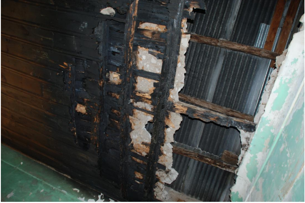
Resim 4.83. 101 mekânının yangın hasarlı ahşap tavanı, Temmuz 2011 [31]
