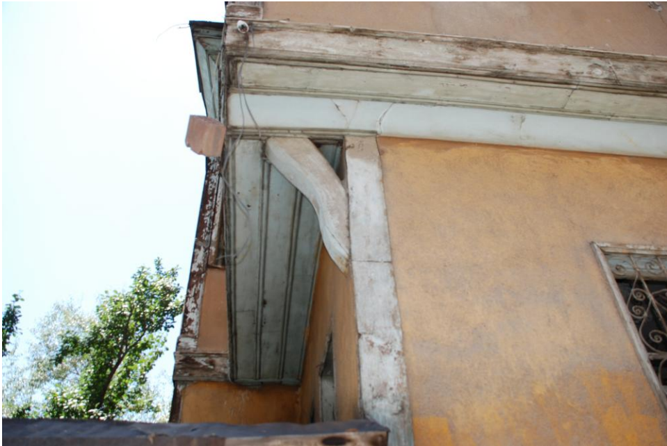
Resim 4.18. Güney ve doğu cephelerindeki çıkma altı ahşap kaplama ve göğüsleme, Temmuz 2011 [31]
