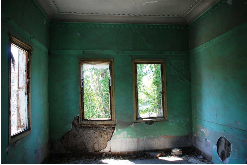
Resim 4.107. 110 mekânı D4 duvarı, Temmuz 2011 [31]
