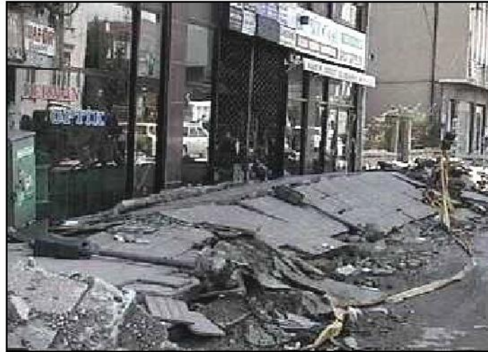
Şekil 2.14. Meydana gelen genel kayma göçmesi (Çinicioğlu, 2005)
