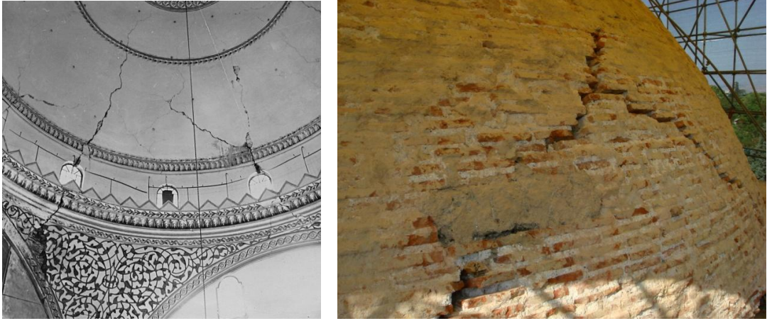
Resim 2.7. Üsküp Mustafa Paşa Camii kubbede diagonal deprem çatlağı, 1968,2008 [55]
