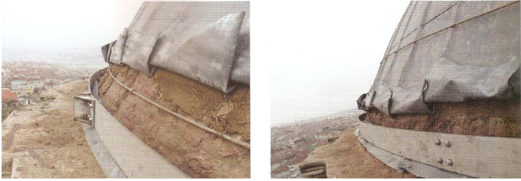
Resim 4.29. Mihrimah Sultan Camii ana kubbe eteğinde uygulanan çekme çemberi [33]
