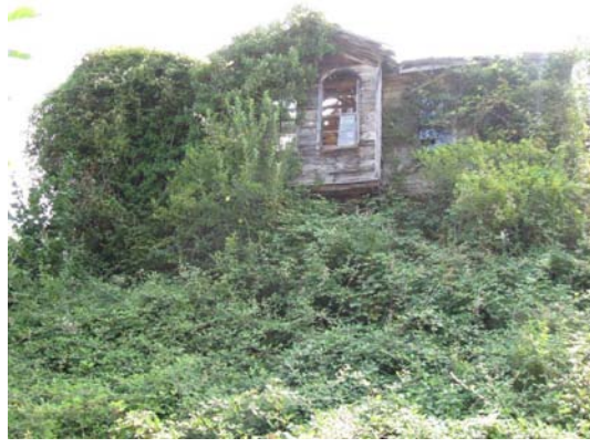
Şekil B.224 : Bitkilenme görülen yapı örneği
