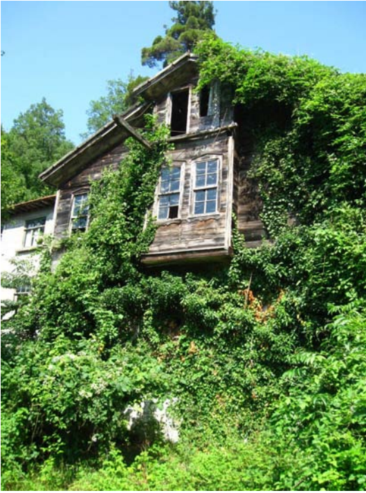
Şekil B.225 : Harabe halindeki yapı
