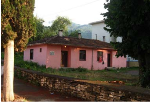
Şekil B.46 : Cumayanı Cami yanında atıl haldeki sağlık evi
