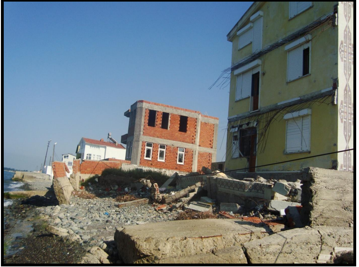
Foto 40. Yakakent Bahçelievler Mahallesi’nde dalga tahribatı sonucu zarar gören yazlık ev
