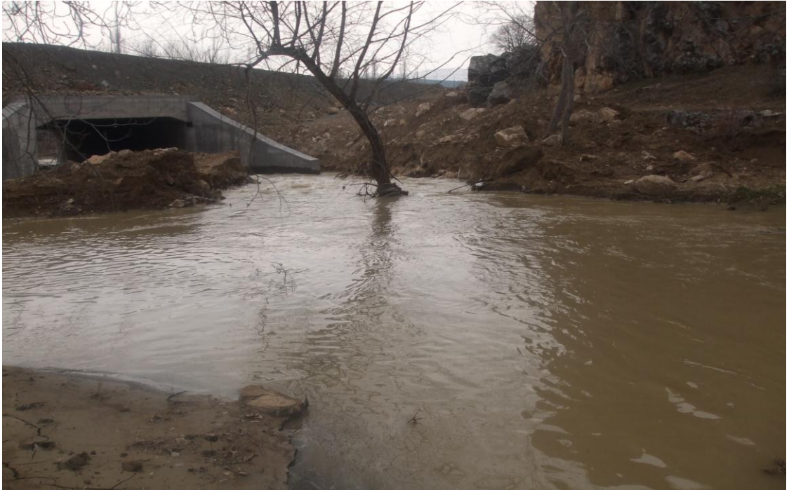
Foto 14: Değirmendere Üzerinde Akarsuyun Yatağını Daraltan Menfezden Bir Görünüm.
