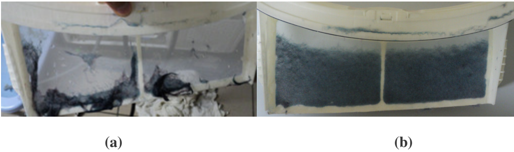
řekil 5.13 : (a) Temizlenmiř filtre (b) Temizlenmemiř filtre.
