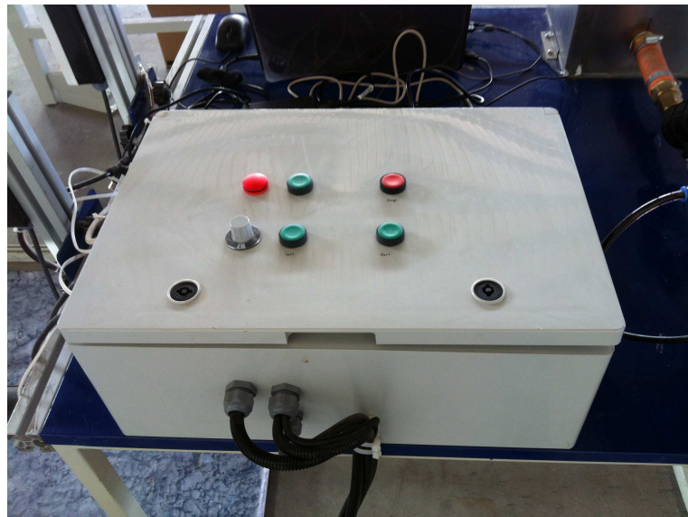
Şekil 3.9. Kontrol ünitesi panosu
