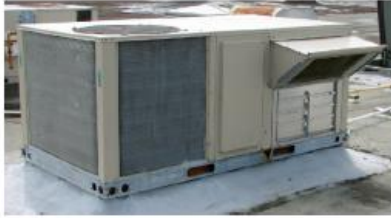
Şekil 1. 21 Çatı tipi klima ünitesi
