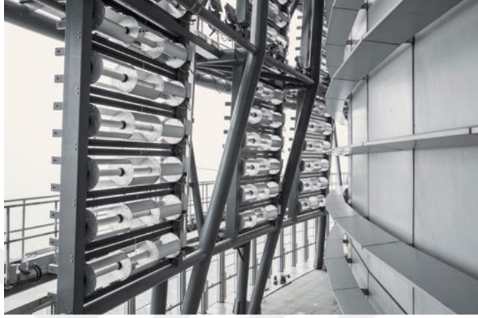
Şekil 3.21: Yapı cephesinde bulunan mikro bütünleşik rüzgar türbinleri (Url-11).
