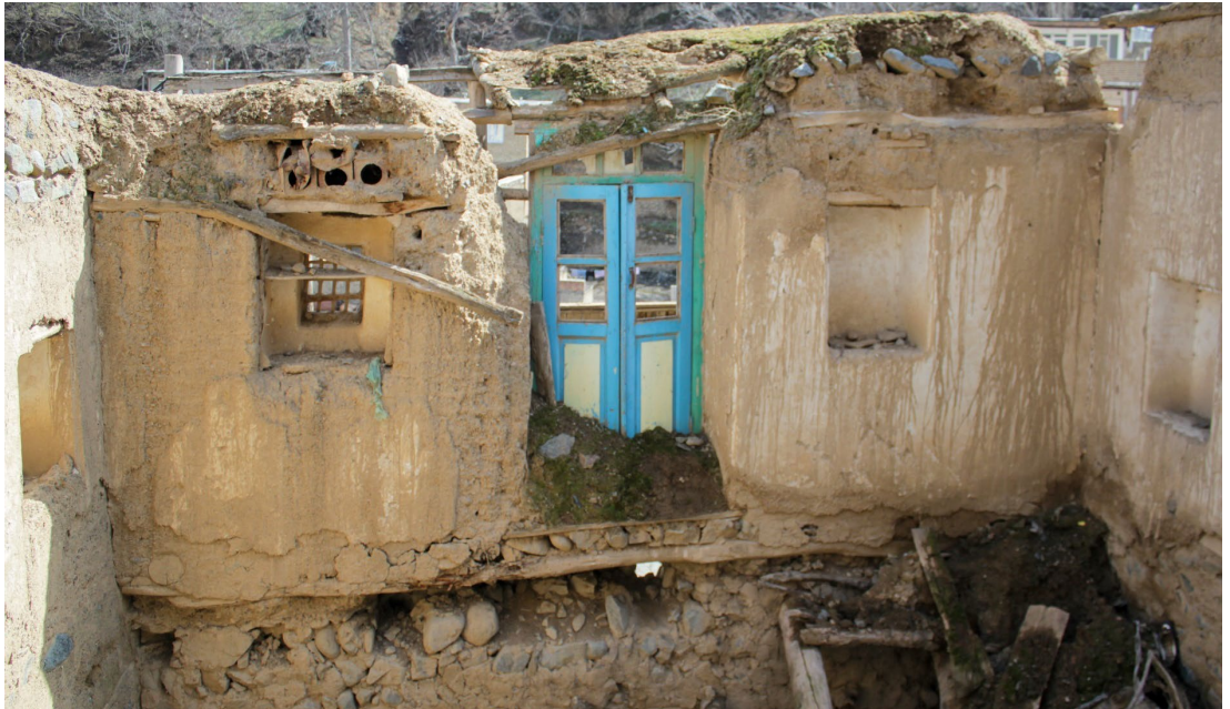
Şekil 5.1 : Yatay ahşap taşıyıcıların kırılması sonucunda yıkılan üst örtü (E-1).
