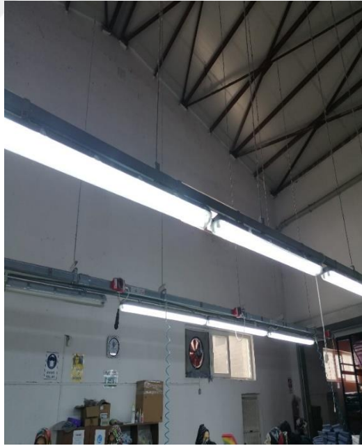
Şekil 3.3.ı: Fabrikanın havalandırma ve aydınlatması
