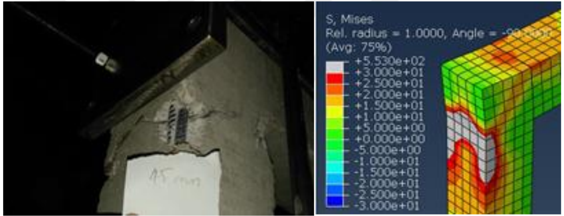
4.12.2 Duvarsız çerçeve için yükleme sonundaki hasar durumu
