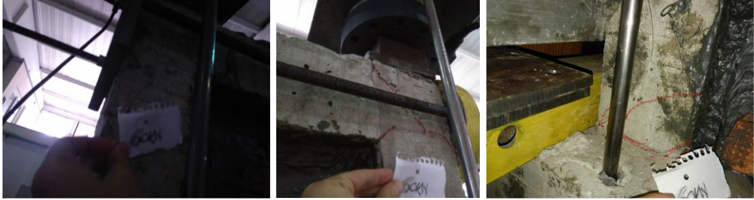
Şekil 3.45. Harçsız duvarlı polimer birleşimli çerçevede 60kN yüklemesindeki hasarlar
