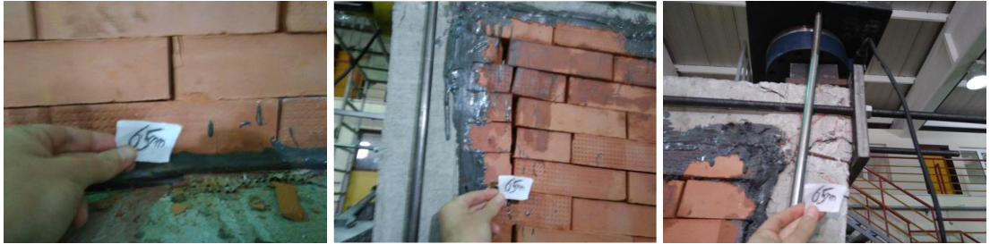
Şekil 3.48. Harçsız duvarlı polimer birleşimli çerçevede 65mm yüklemesindeki hasarlar
