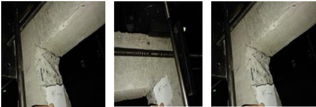
Şekil 3.39. Duvarsız çerçeve 60kN yüklemesinde hasarlar.
