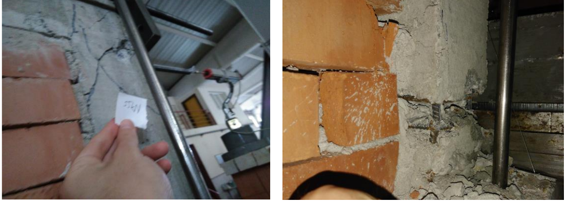
Şekil 3.31. Harçsız duvarlı harçlı birleşimli çerçevede maksimum yükte hasarlar
