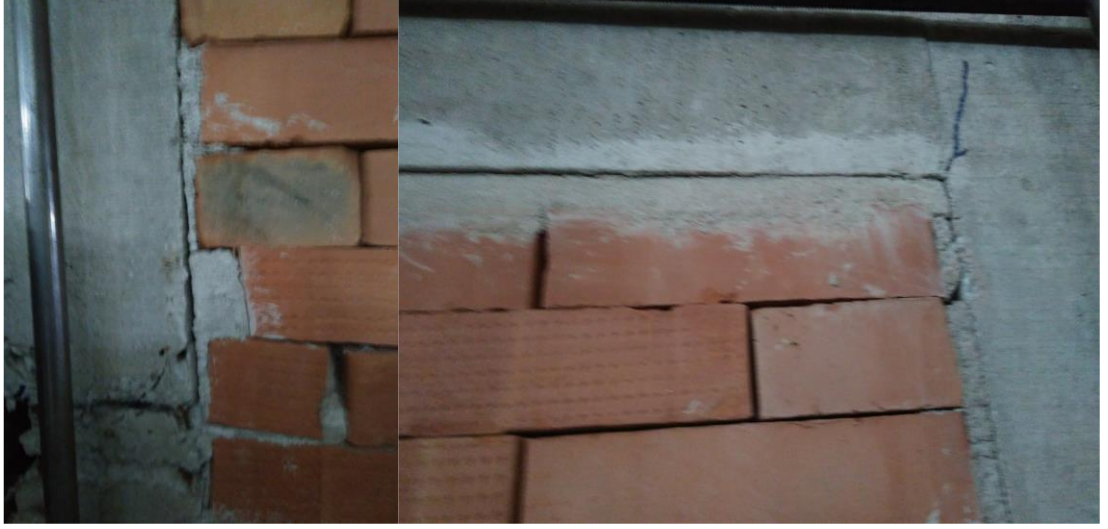
Şekil 3.27. Harçsız duvarlı harçlı birleşimli çerçevede oluşan ilk çatlaklar
