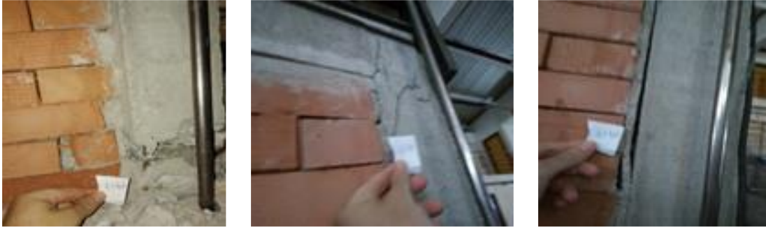
Şekil 3.29. Harçsız duvarlı harçlı birleşimli çerçevede 45kN’da oluşan çatlaklar ve duvar ile çerçevenin ayrışması
