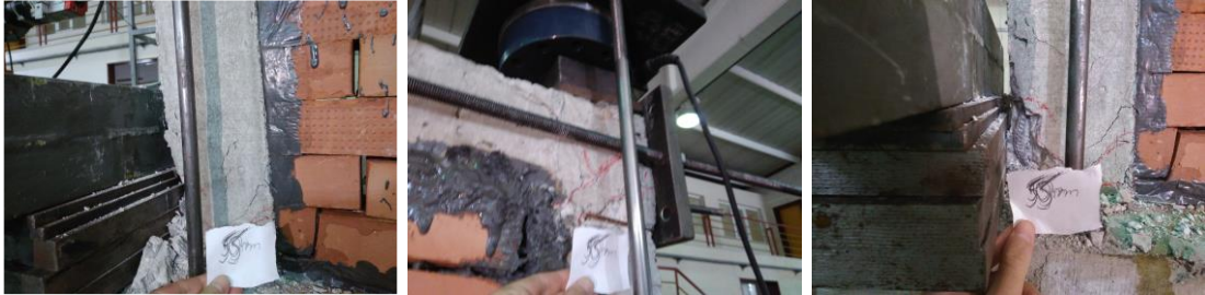
Şekil 3.46. Harçsız duvarlı polimer birleşimli çerçevede 55mm yüklemesindeki hasarlar
