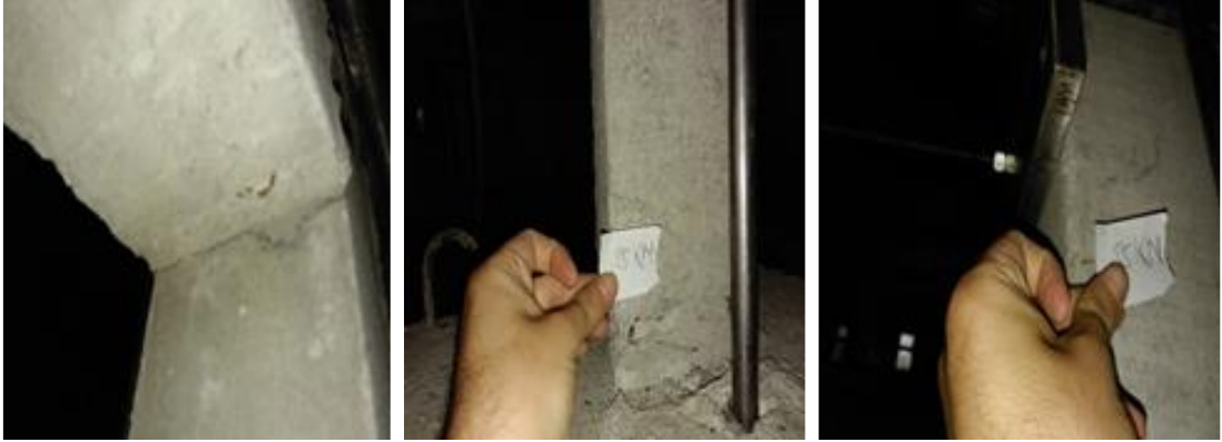
Şekil 3.38. Duvarsız çerçeve 55kN yüklemesinde hasarlar
