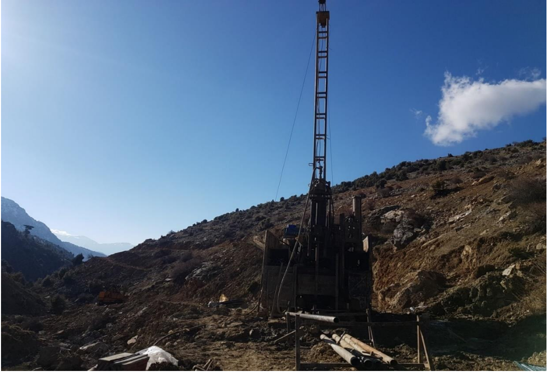
Şekil 4.9. Bsk-1 nolu sondaj kuyusundan (batardo) bir görünüm
