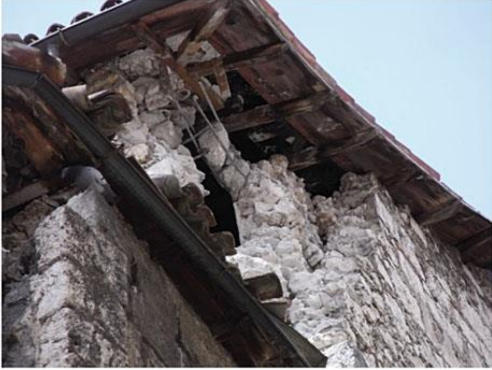
Şekil 3.19 : Sonradan yapılan çatı yapısının oluşturduğu hasar, Santa Giusta Kilisesi, L'aquila (D'Ayala, 2014).
