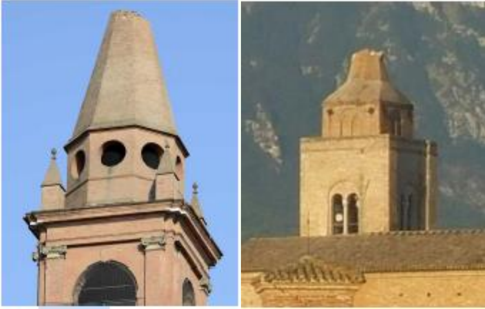
Şekil 3.24 : Çıkıntı ve çan hücresi hasarları (Zanazzi ve diğ., 2019).
