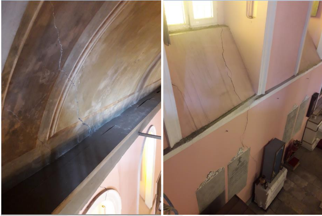
Şekil 5.10 : Yan nef tonozu ve altındaki duvarda oluşan çatlaklar.
