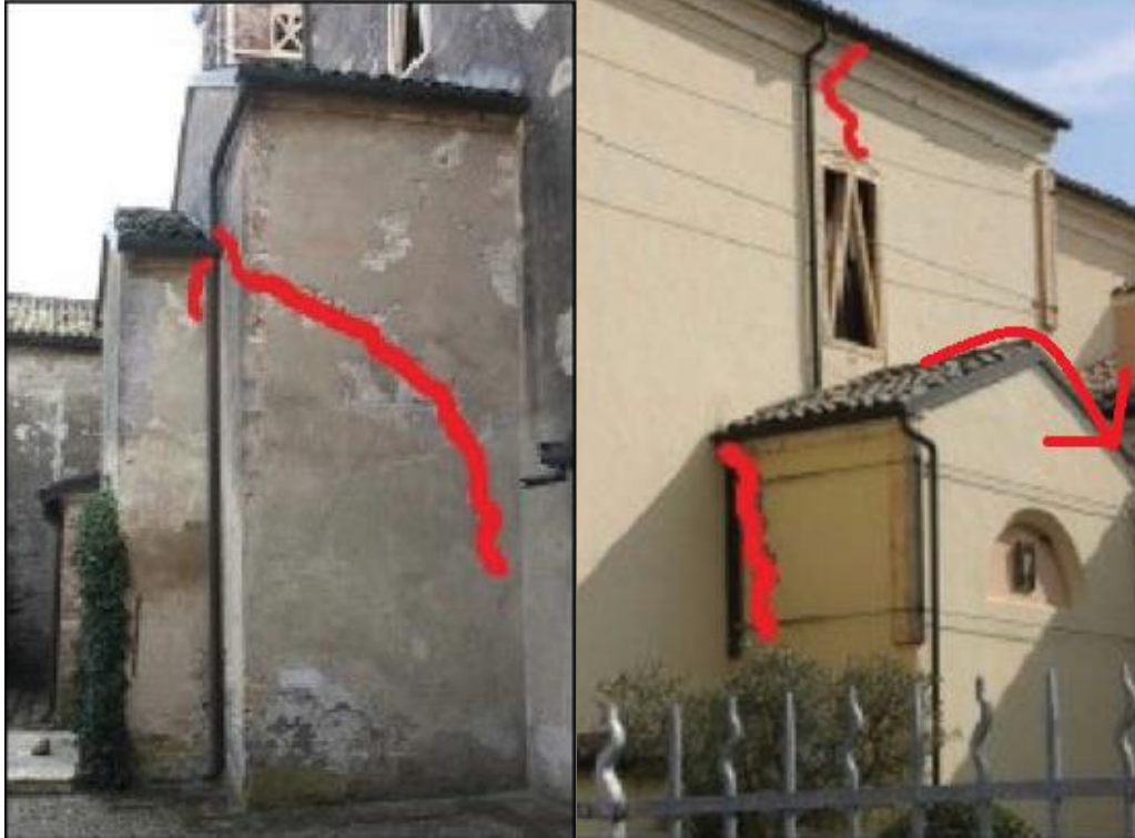
Şekil 3.21 : Kilise ek yapılarında oluşan hasarlar San Pietro Apostolo Kilisesi Ferrara, İtalya (Valente ve Milani, 2018).
