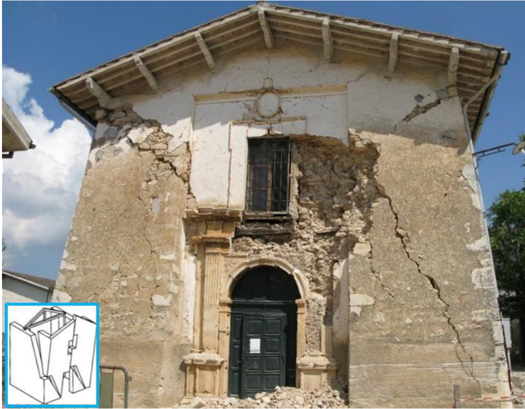
Şekil 3.14 : Cephe kesme çatlağı örneği – Sant' Antonio Abate Kilisesi (Hofer ve diğ., 2018).
