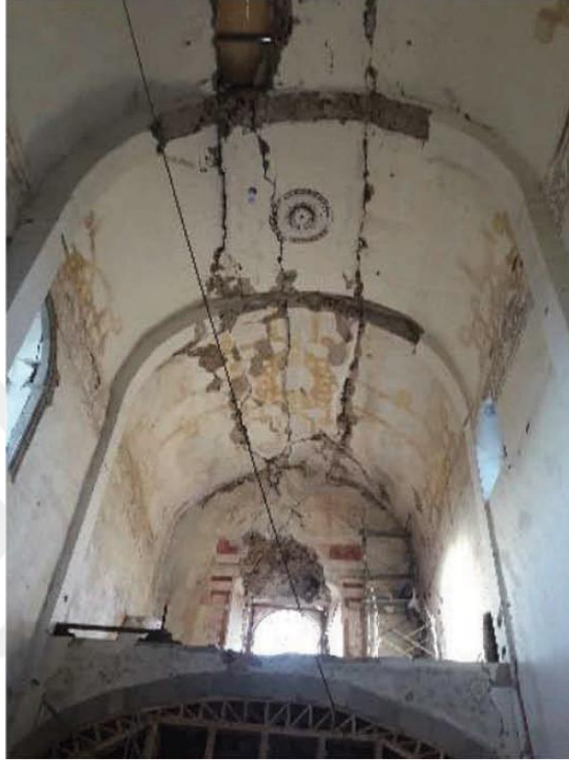
Şekil 3.15 : Naosta enine hasar mekanizması, San Juan Bautista Kilisesi, Morelos (Fuentes ve diğ., 2019).
