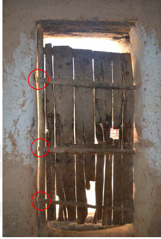
Şekil 5.45 Ahşap çakma kapıda kuşaklarla kapıya bağlanan ahşap direk, 2020
