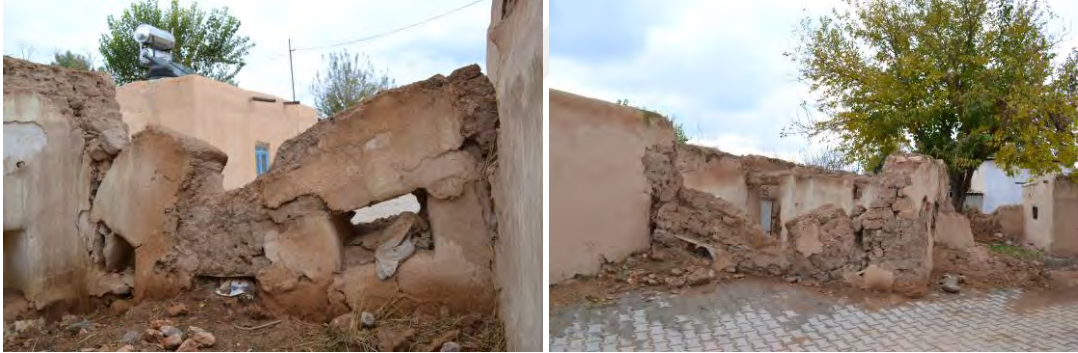
Şekil 6.23 Suya doyan kerpiç duvarlarda göçme, 2019
