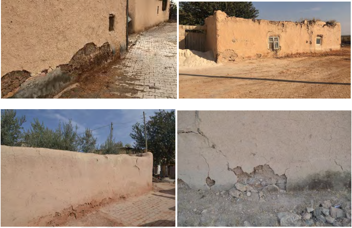
Şekil 6.22 Zeminden su yükselmesi ya da akan sular nedeniyle sıvaları dökülen kerpiç duvarlar, 2019
