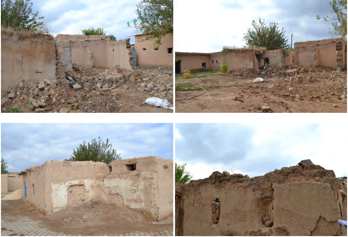
Şekil 6.51 Terk ve bakımsızlık sonucu hasar görmüş ve yıkılmış yapılar, 2019
