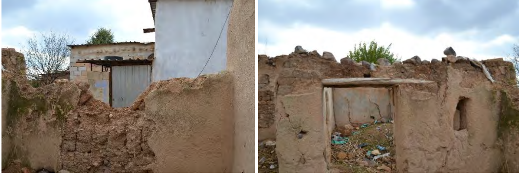
Şekil 6.19 Bünyesine fazla su alan ve yıkılan kerpiç duvar ve düz toprak dam, 2019 Her yıl temizlenmesi gereken düz toprak damların temizlenmeyip üzerlerinde biten otların büyümesi, toprağın yağmur sularını bünyelerine daha çok çekmelerine sebep olmuş, yükü artan damlar, ahşap malzemelerin de taşıyıcılık özelliklerini kaybetmesiyle çökmüştür (Şekil 6.20). Damları çöken yapılar hava koşulları karşısında daha da savunmasız hale gelmiştir. Duvarların iç sıvalarında ve kerpiç bloklarında da bozulmalar olmuştur.
