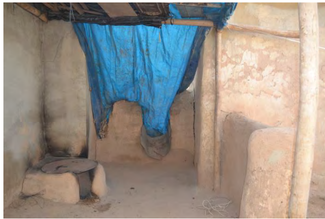
Şekil 6.11 Ön duvarı yıkılmış ocaklık birimi, 2020
