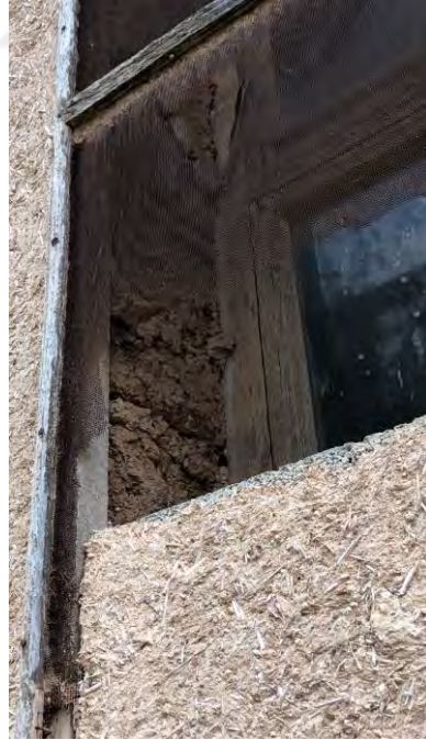
Şekil 5.118 Özgün sıvası dökülen duvar, 2020
