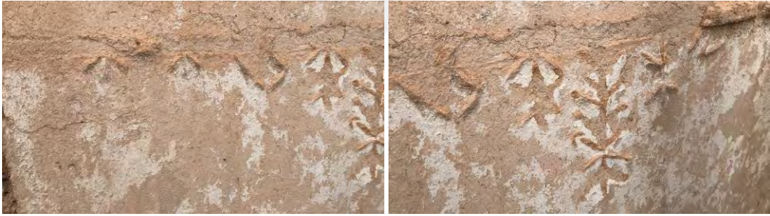
Şekil 6.13 Yıkılmış oda duvarında izleri kalan sıvayla yapılmış özgün süslemeler, 2019
