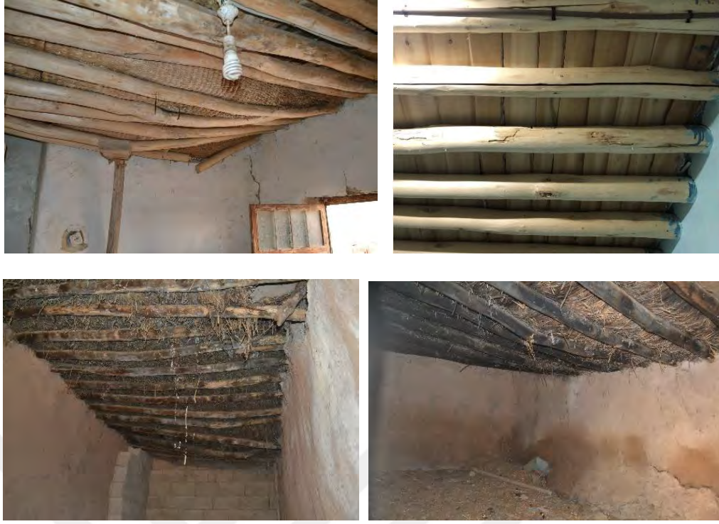
Şekil 6.24 Ahşap kirişlerdeki bozulmalar, 2020
