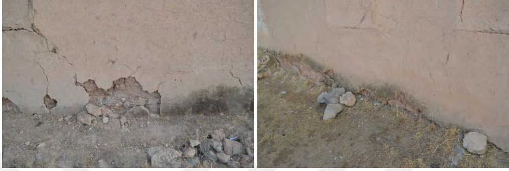
Şekil 5.117 Zemin seviyesinde görülen duvar bozulmaları, 2020
