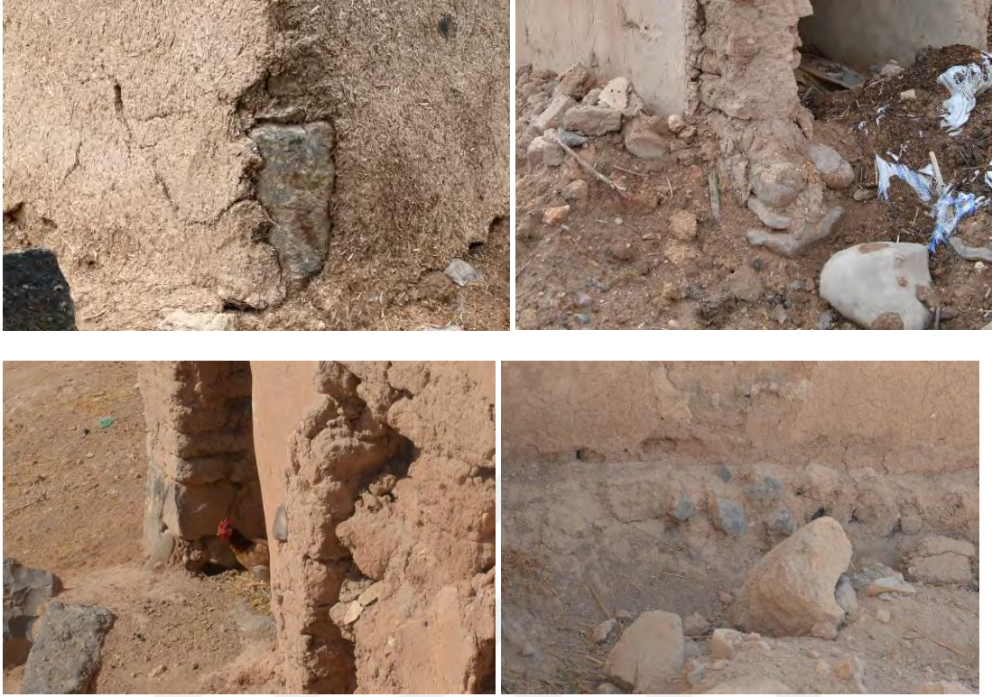
Şekil 5.88 Yapı temelindeki su basmanı da oluşturan taşlar, 2019
