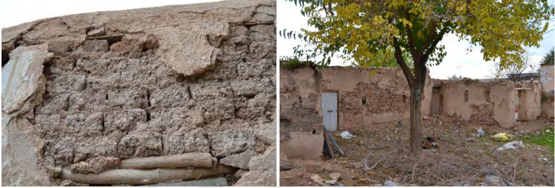
Şekil 6.52 Sıvaları dökülen ve kerpiç blokları açıkta kalan ve yıkılan kerpiç duvarlar, 2019
