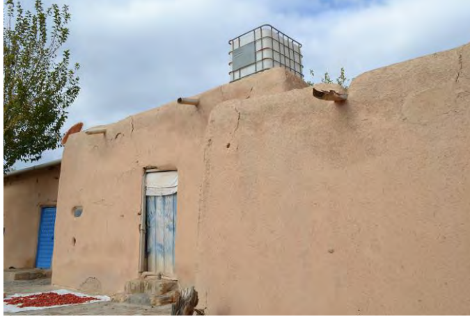
Şekil 6.47 Plastik boru ile değiştirilmiş çörtenler, 2019
