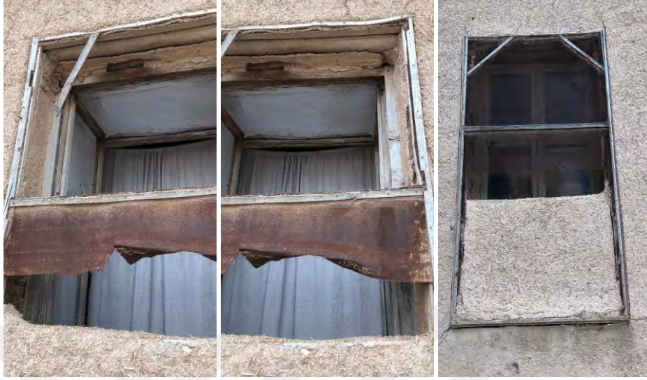
Şekil 5.119 Özgün ahşap doğramalarda görülen bozulmalar, 2020
