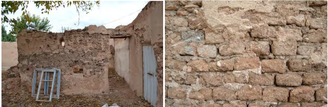
Şekil 6.18 Yağış ve rüzgâr sebebiyle özgün çamur sıvaları dökülen, çamur derzleri aşınan kerpiç duvarlar, 2019
