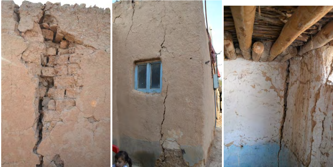
Şekil 6.25 Dam yükü ve deprem hareketlerinden kaynaklanan yapısal çatlaklar, 2019
