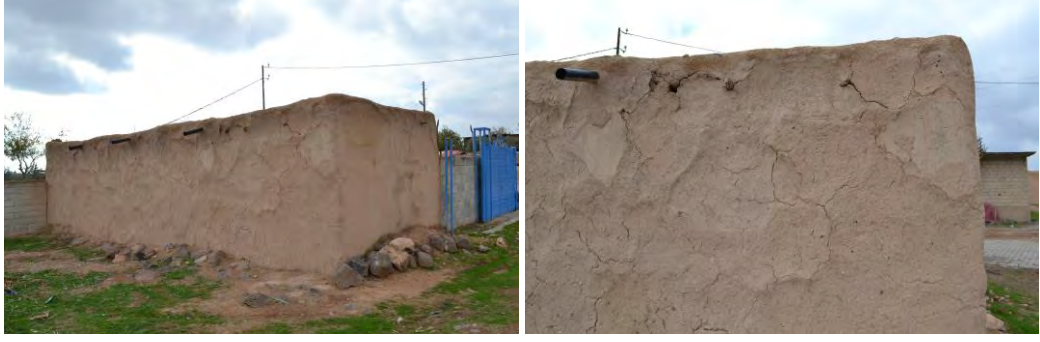
Şekil 6.27 Killi toprakla sıvanan kerpiç duvarda görülen sıva çatlakları, 2019
