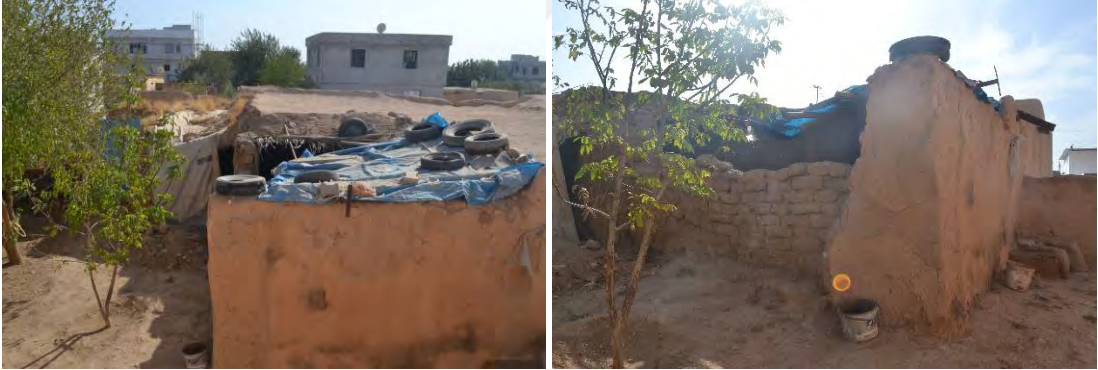
Şekil 6.53 Bakımsızlık sonucu yıkılmış toprak dam ve kerpiç duvar, 2020
