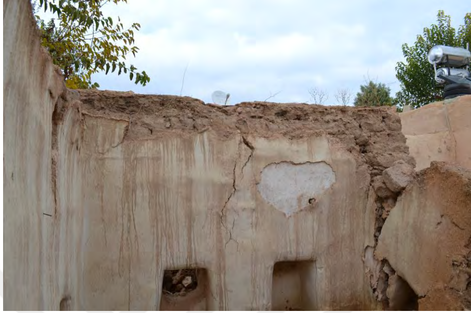
Şekil 6.21 Bozulmuş damdan fazla yük alan kerpiç duvarda görülen çatlaklar, 2019
