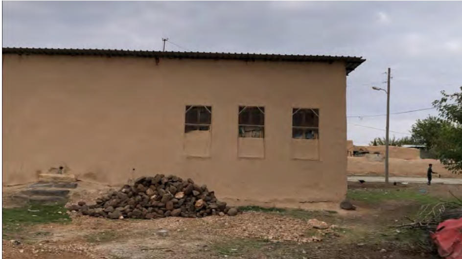
Şekil 5.120 Kerpiç bloklarla yarı seviyesine kadar kapatılan özgün pencereler, 2020
