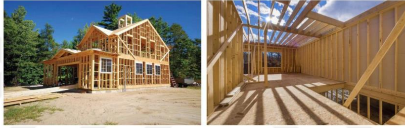
Şekil 75 Ahşap yapıda dikey taşıyıcı elemanlarda ahşap kullanımı.(URL 109)
