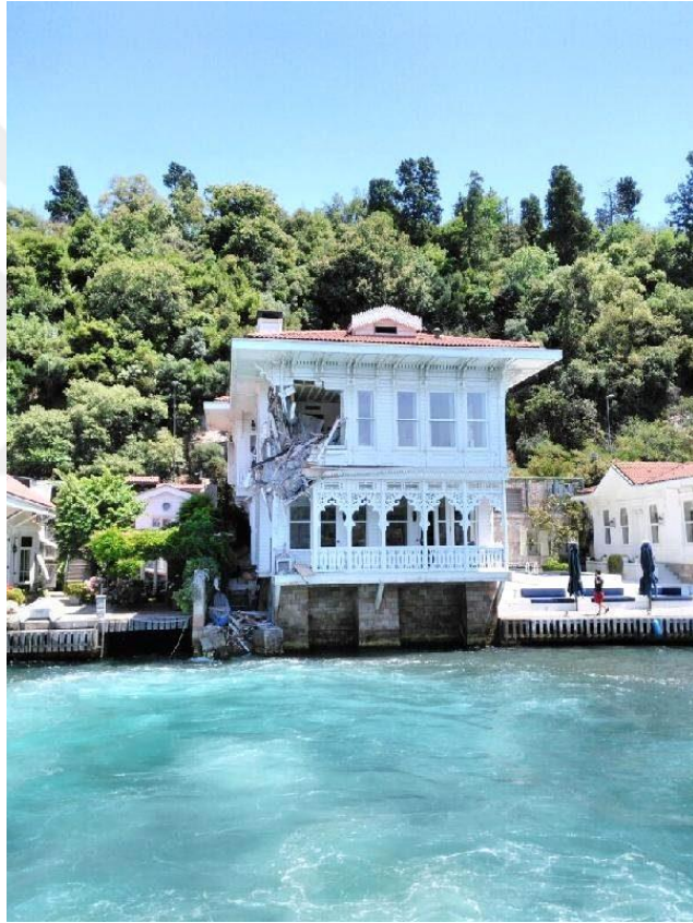
Şekil 3.15 Boğazda Bir Geminin Yalıya Çarpması Sonucu Oluşan Hasar
