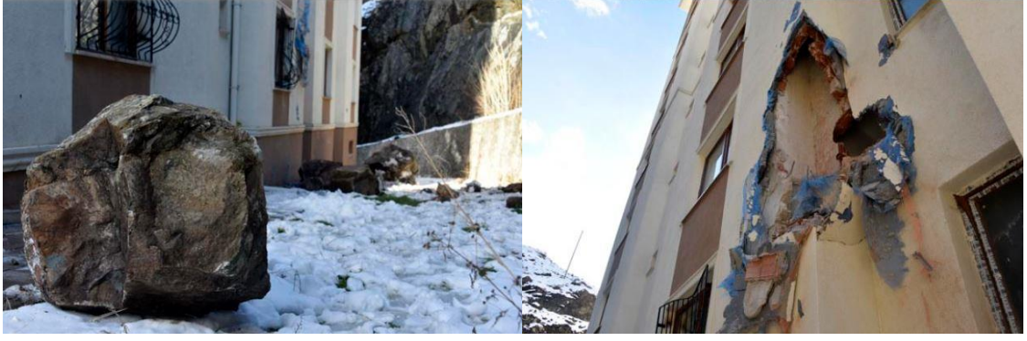
Şekil 3.14 Gümüşhane’de Betonarme Bir Binaya Düşen Kaya Parçaları
