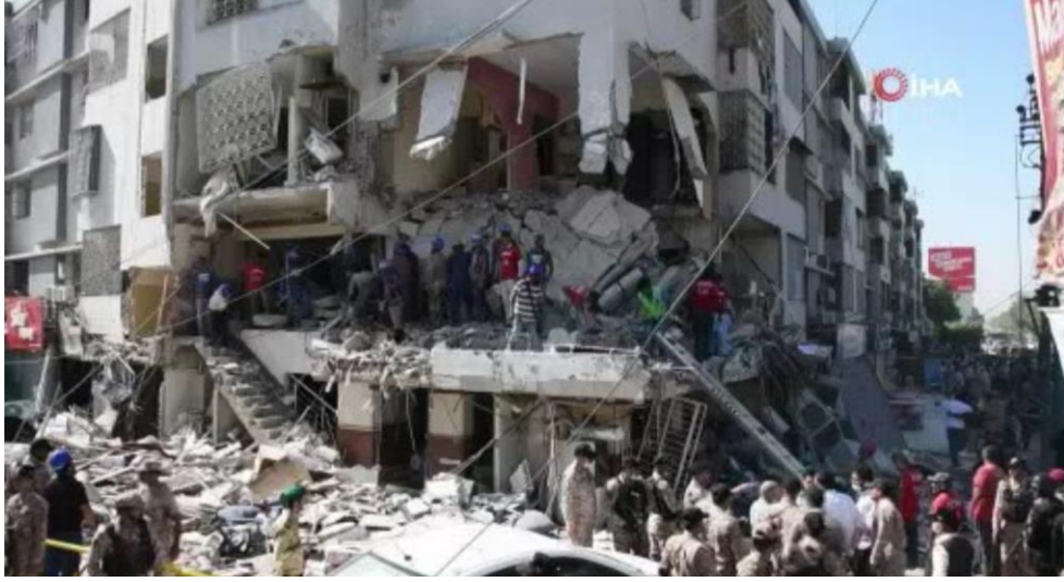
Şekil 3.16 Pakistan’da Betonarme Bir Binada Gerçekleşen Patlama Sonrası Oluşan Hasarlar
