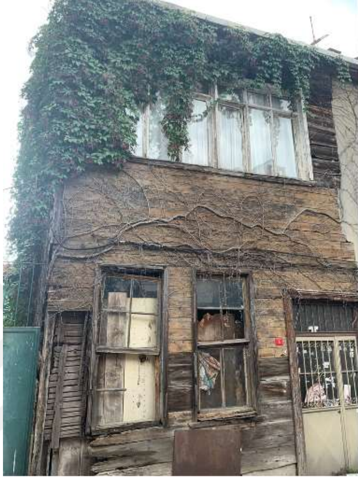
Şekil 1.106 Büyük oranda zarar görmüş yapı
