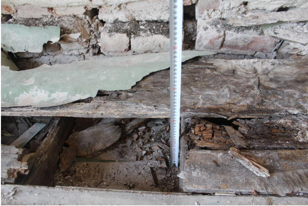
Şekil E.52: Ahşap döşeme kirişlerinde bozulmalar.
