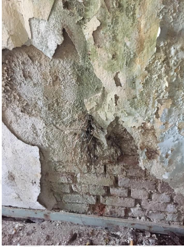
Şekil E.61: Z03 Mutfak mekânında sıva kayıpları ve yosun oluşumu.
