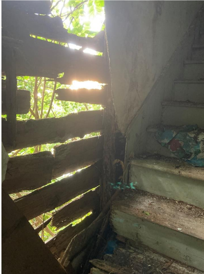
Şekil E.54: Kuzey cephesinde kesit kaybı.
