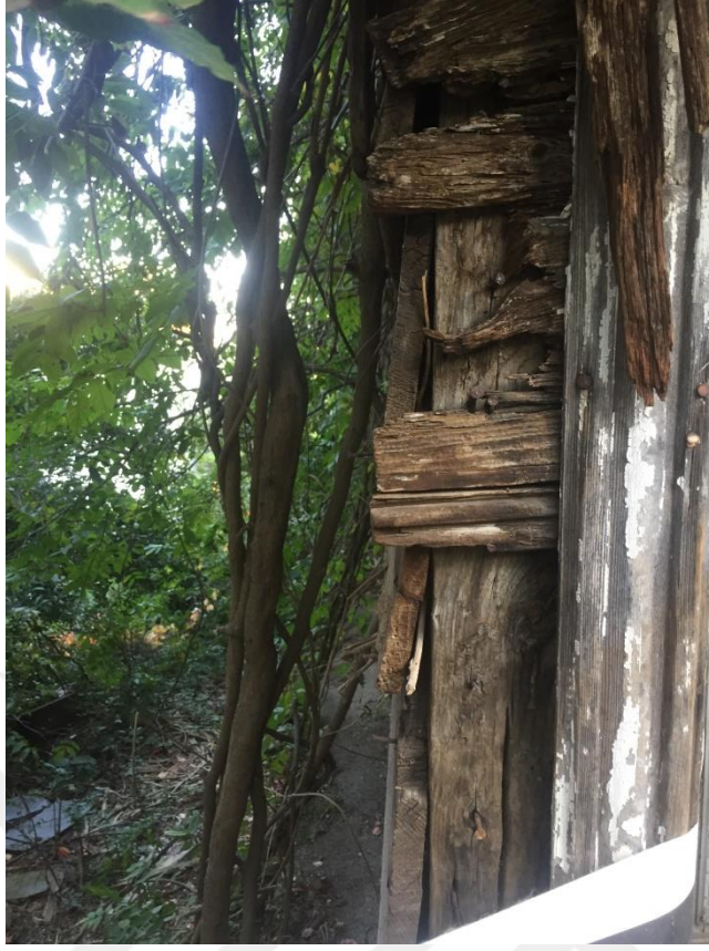
Şekil E.65: Batı cephesinde ahşap cephe kaplamalarında bozulma.
