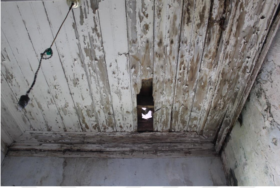
Şekil E.57: Z03 Mutfak mekânının tavan döşemesindeki bozulma.
