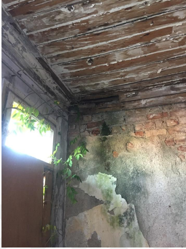
Şekil E.59: 106 Oda mekânında sıva kayıpları ve yosun oluşumu.
