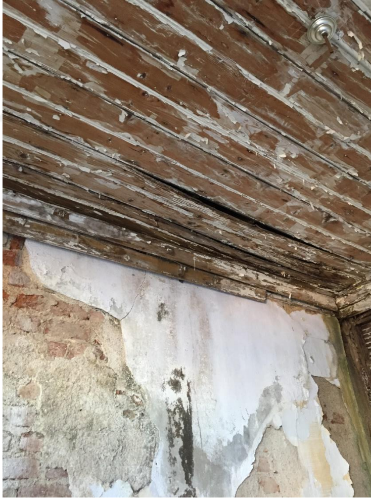
Şekil E.58: 106 Oda mekânındaki tavan döşemesindeki bozulma.
