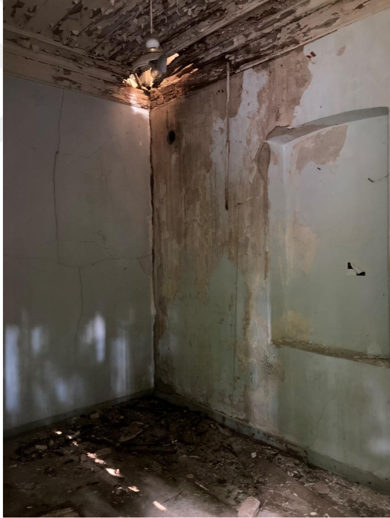
Şekil E.56: Z02 Oda mekânının tavan döşemesindeki bozulma.
