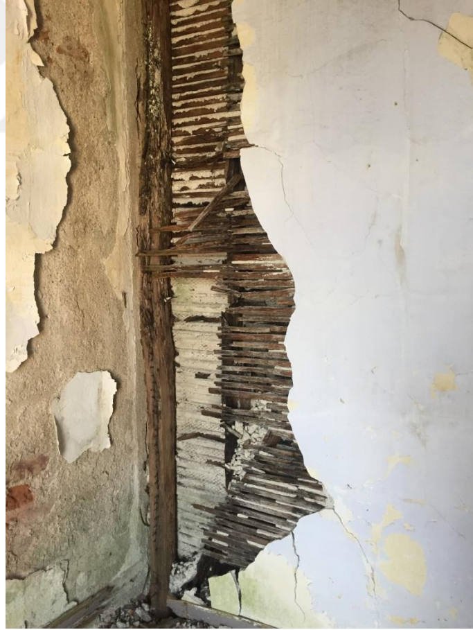
Şekil E.36: 106 Oda mekânında bulunan ahşap bağdadi tekniği ile örülmüş duvar ve ahşap malzemelerdeki bozulmalar.
