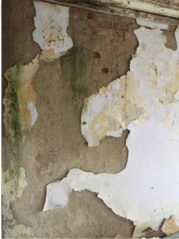
Şekil E.60: 104 Oda mekânında sıva kayıpları ve yosun oluşumu.
