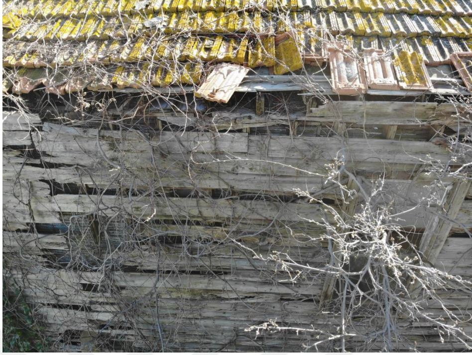
Şekil E.63: Ahşap yalıbaskı cephe kaplamasında malzeme kaybı.
