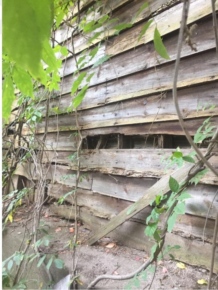
Şekil E.64: Ahşap yalıbaskı cephe kaplamasında malzeme kaybı.
