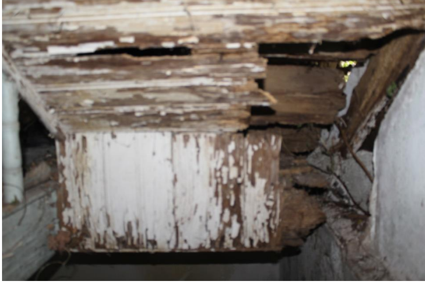
Şekil E.55: Merdiven basamak ve kirişinde bozulma ve malzeme kaybı.
