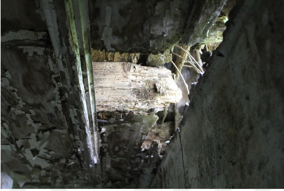
Şekil E.53: Ahşap döşeme kirişlerinde bozulma.
