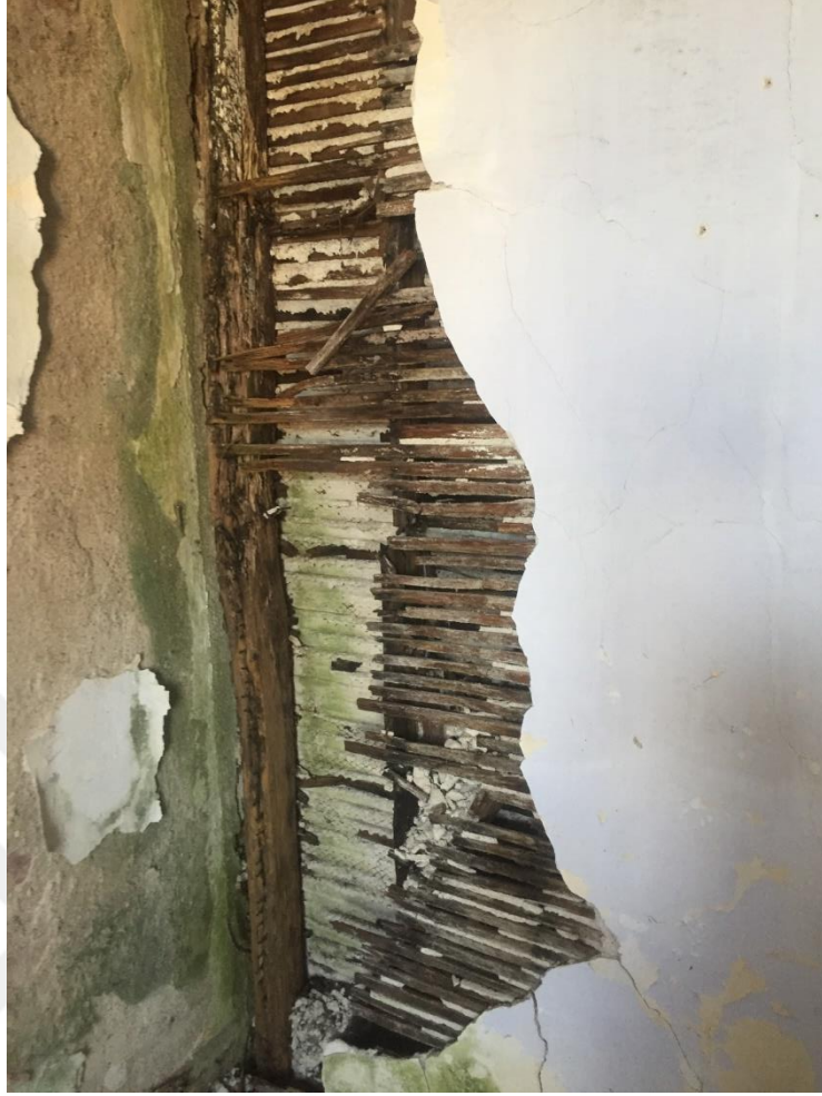
Şekil E.51: 106 Oda mekânında ahşap karkas detayı ve bozulmaları.
