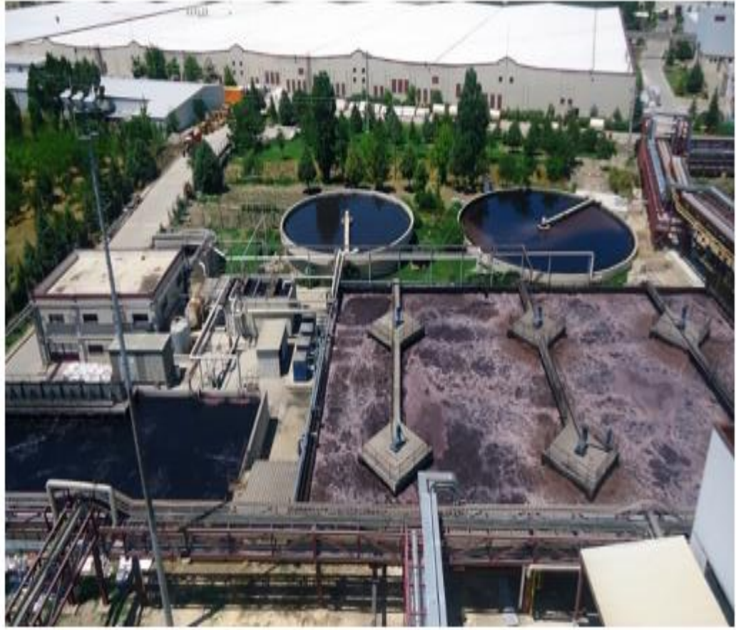
Şekil 3. 1. Tekstil atık su arıtma tesisinin genel görünümü
