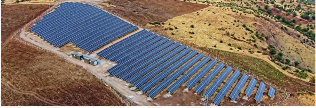
Resim 2.3 1MW zemin monteli güneş enerji santrali [24]
