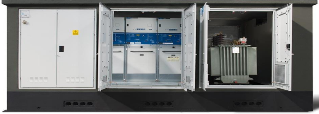
Resim 3.29 Örnek Trafo Köşkü [53]
