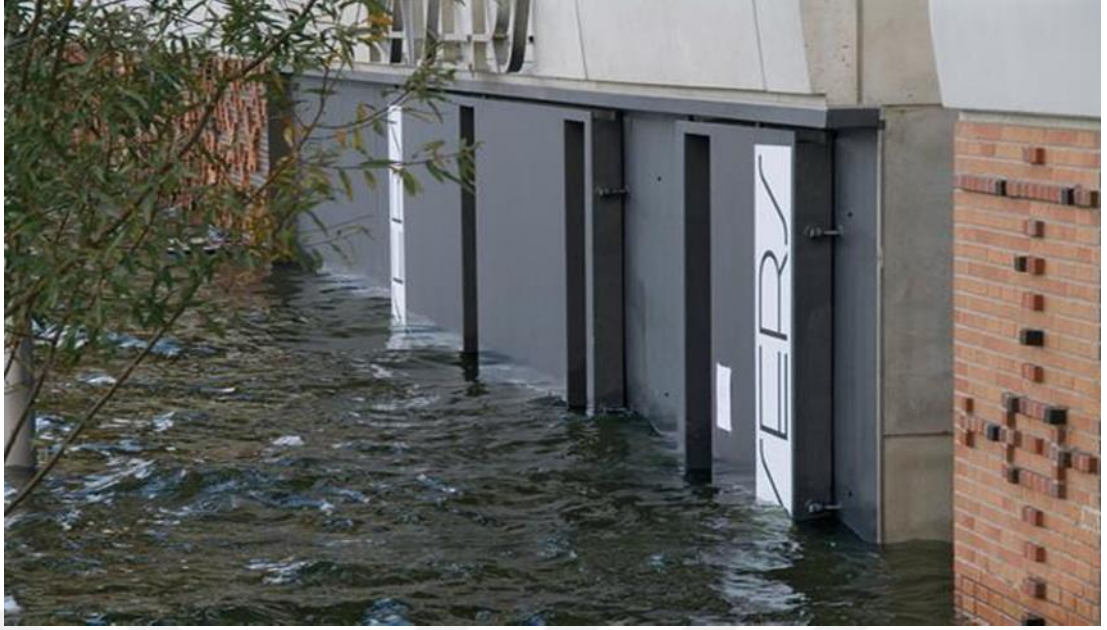
Şekil 4.38 : Sel durumunda zemin kotundaki mekanları koruyan su geçirmez kapaklar. (Lemcke Knoll, 2012)
