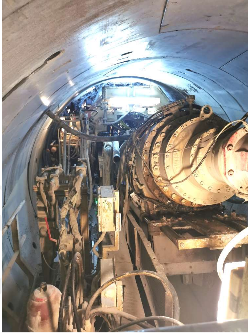
Şekil 3.9. Hadim-Afşar-Bağbaşı su ikmal tüneline kullanılan EPB-TBM'in içeriden görünümü
