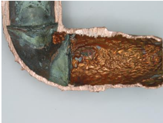
Şekil 3.7: Erozyon korozyonuna uğramış bakır boru kesit görüntüsü.
