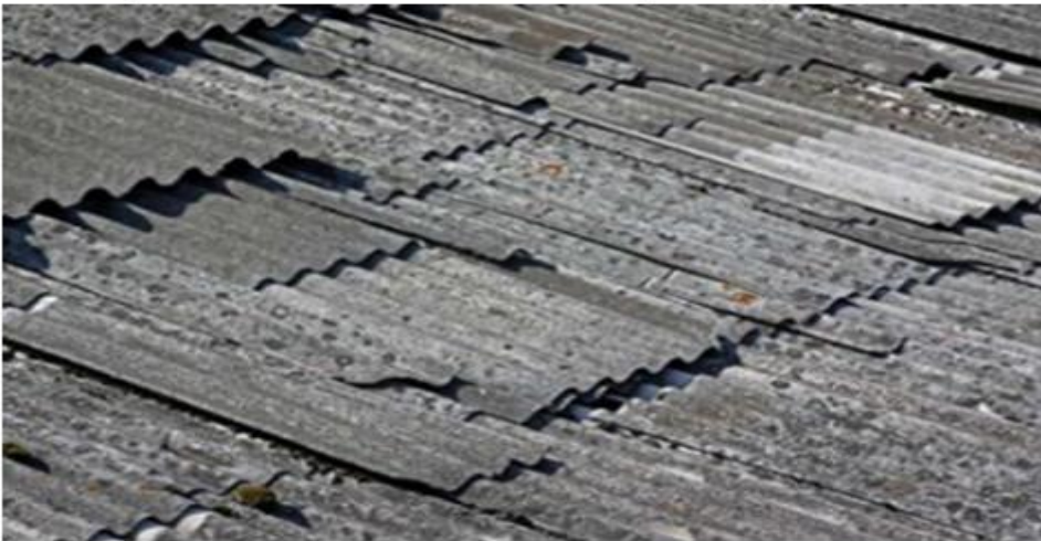
Resim 2.13. Asbest ve ağır metal içeren çatı kaplaması (Kaynak: Şahin vd., 2022)
