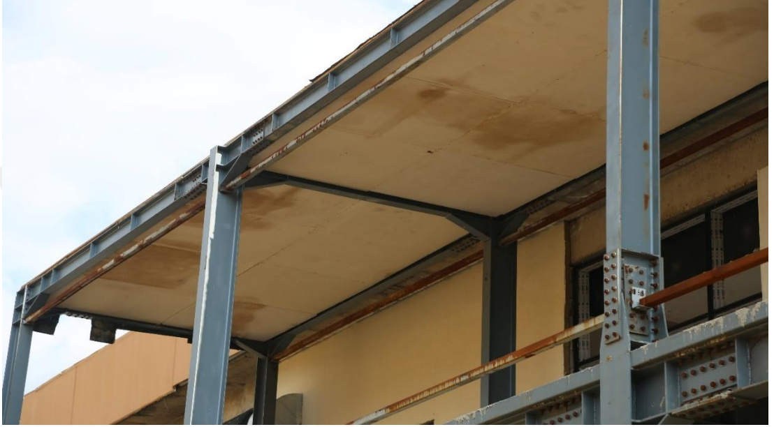
Şekil 4.1. Geçiş köprüsü tavanı-fibercement kaplamalarının fesih sonrası durumu.
