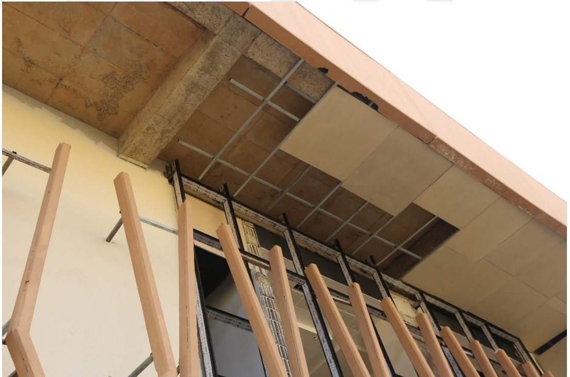
Şekil 3.11. Fesih sonrası yemekhane binası alın imalatlarının durumu.
