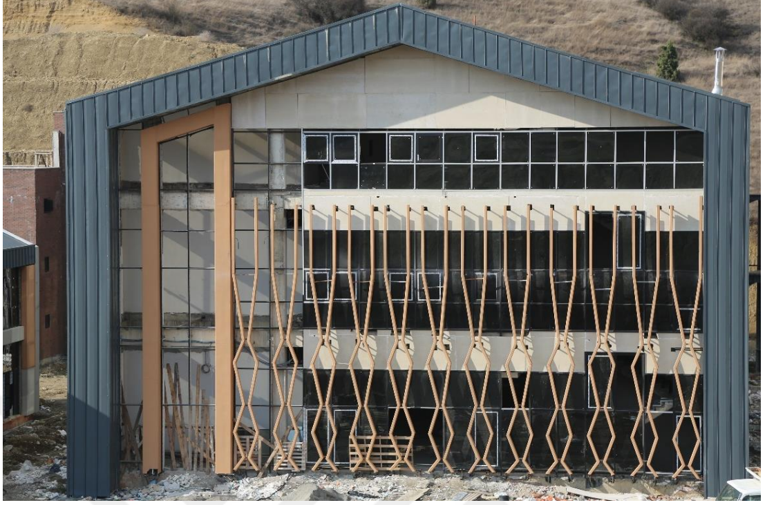
Şekil 3.10. Fesih sonrası atölye binası ön cephenin durumu.
