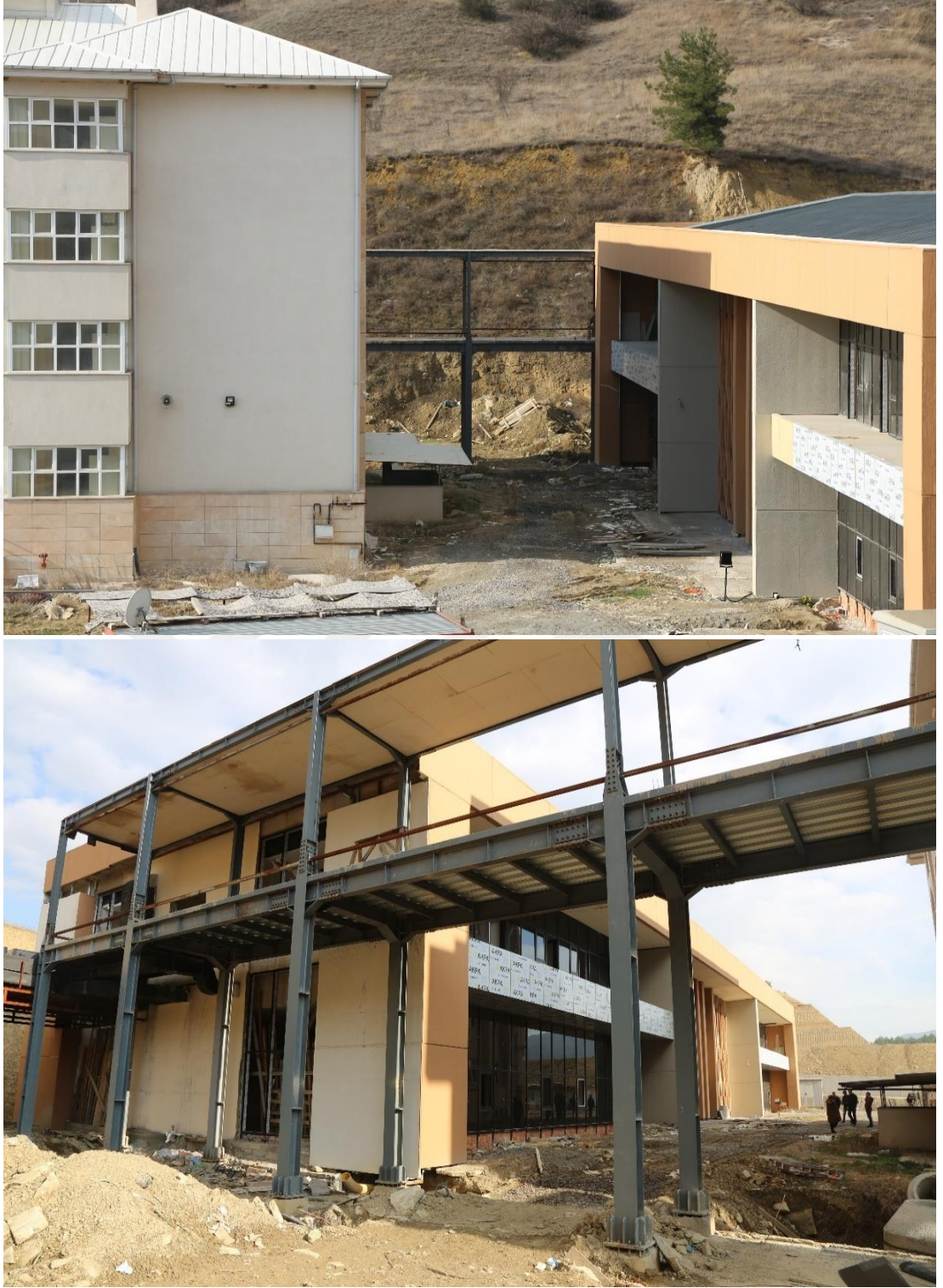
Şekil 3.7. Fesih sonrası ana bina-yemekhane binası arası köprünün durumu.
