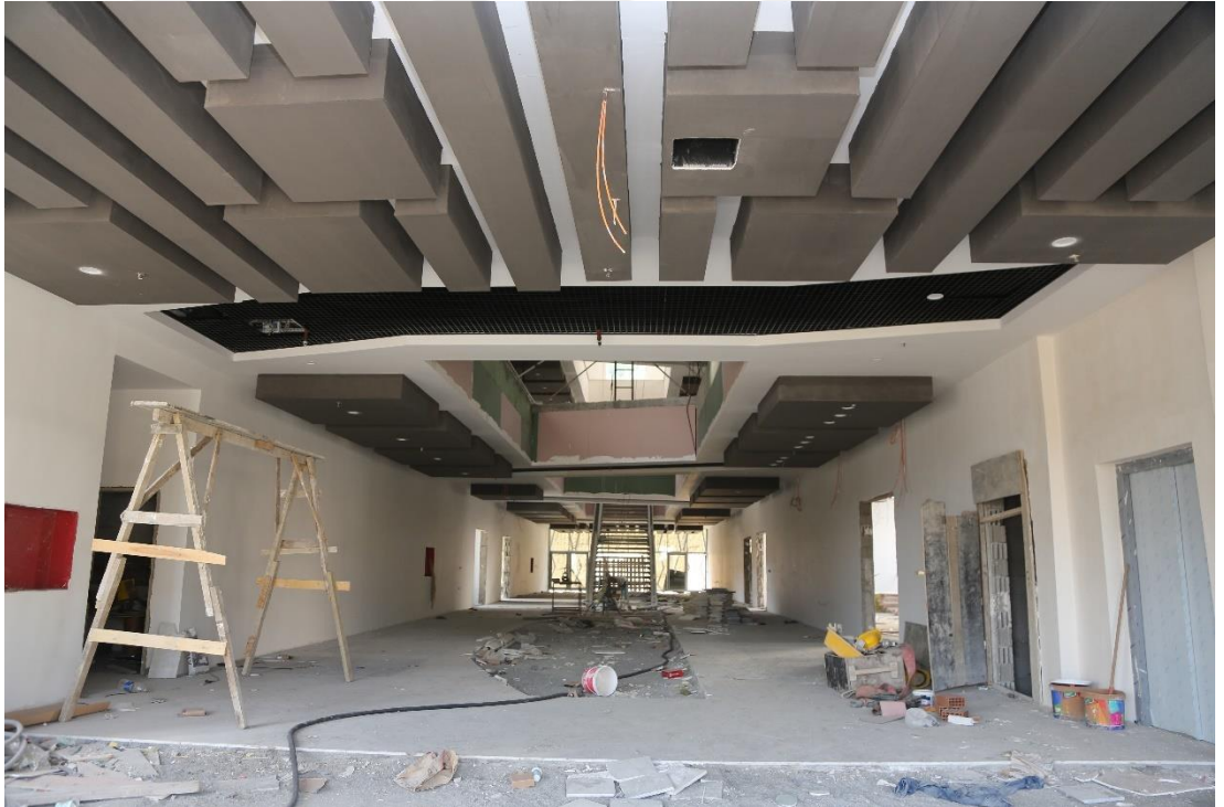
Şekil 4.5. Fesih sonrası atölye binası zemin katının durumu.
