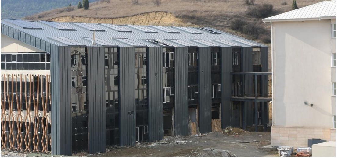
Şekil 3.8. Fesih sonrası atölye binası yan cephesinin durumu.
