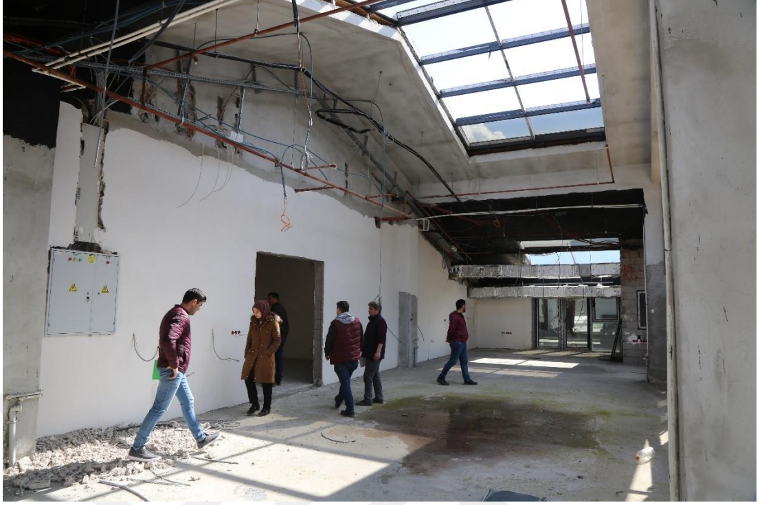
Şekil 4.4. Fesih sonrası atölye binası son katın durumu.
