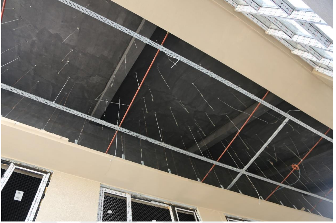
Şekil 3.18. Fesih sonrası garaj binası tavan imalatlarının durumu.
