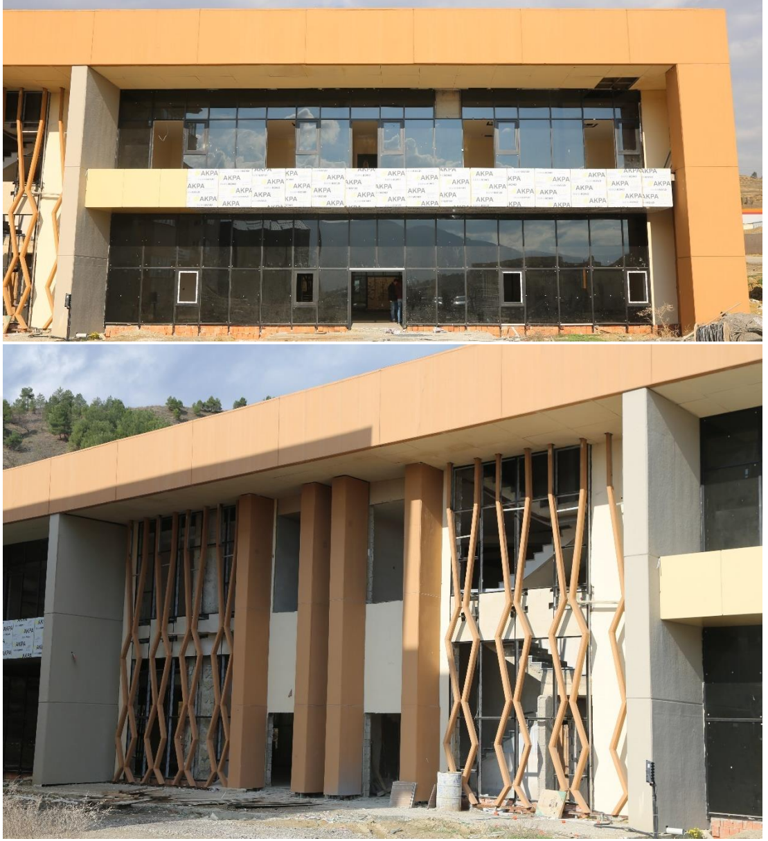
Şekil 3.13. Fesih sonrası yemekhane binası ön cephesinin durumu.
