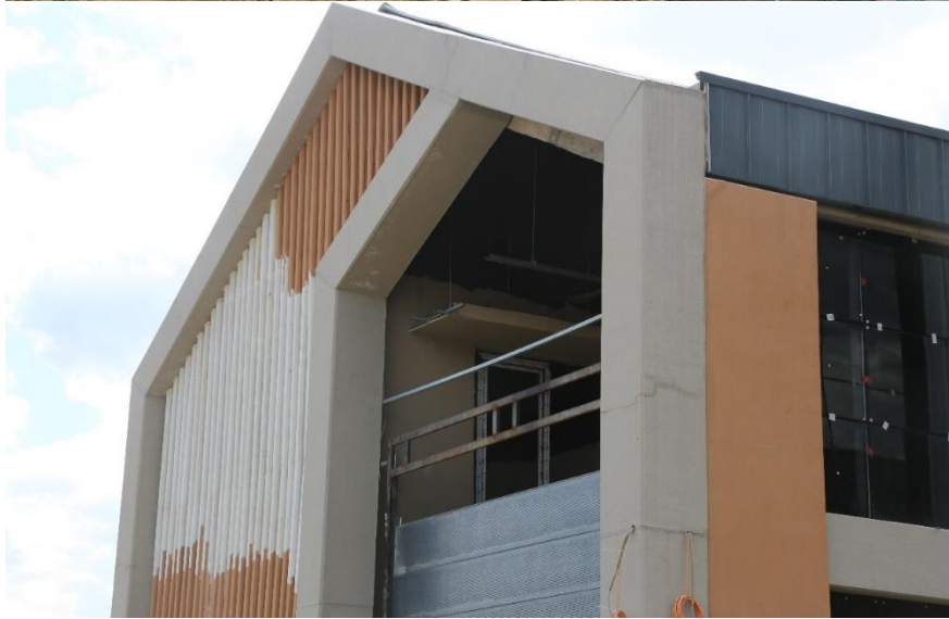
Şekil 3.16. Fesih sonrası garaj binası ön cephesinin durumu.
