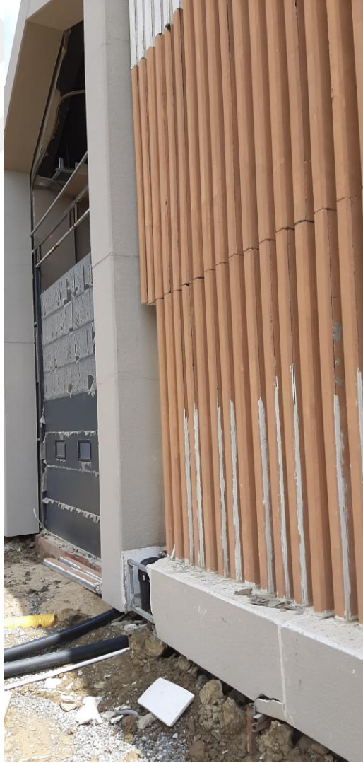
Şekil 3.26. İlk yüklenici tarafından yarım bırakılan mesh süs cephe imatları.
