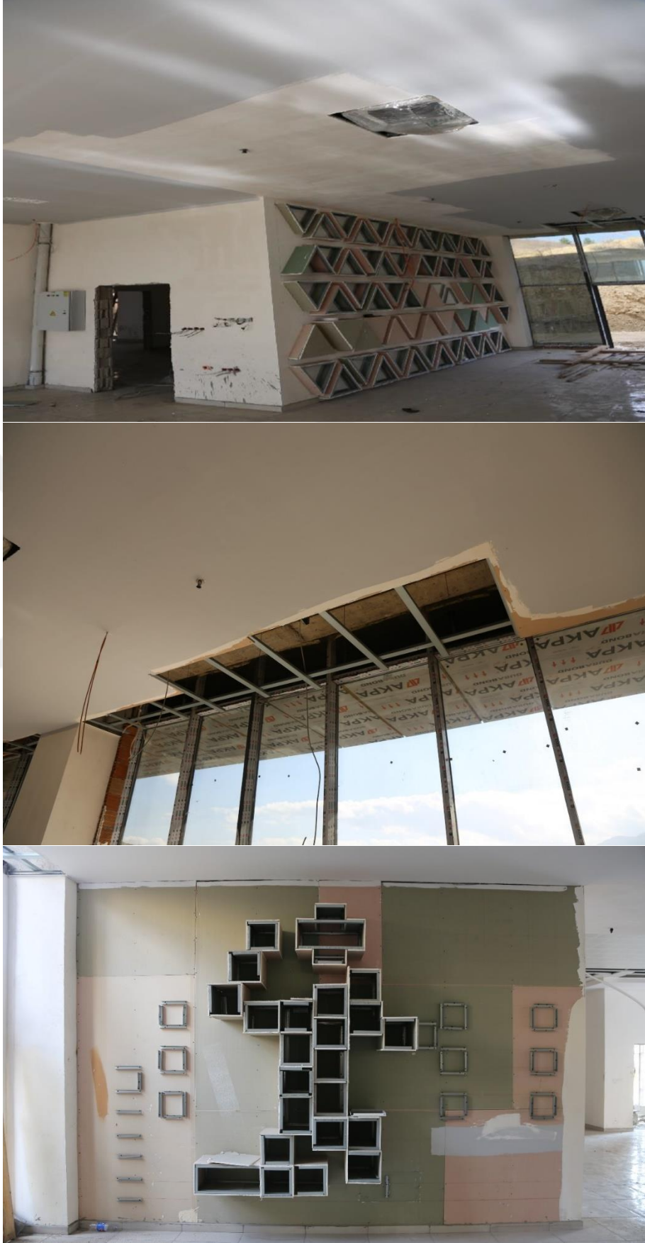
Şekil 3.14. Fesih sonrası yemekhane binası iç imalatlarının durumu.
