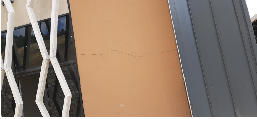
Şekil 3.27. İlk yüklenici tarafından kırık bırakılan prekast cephe imatları.
