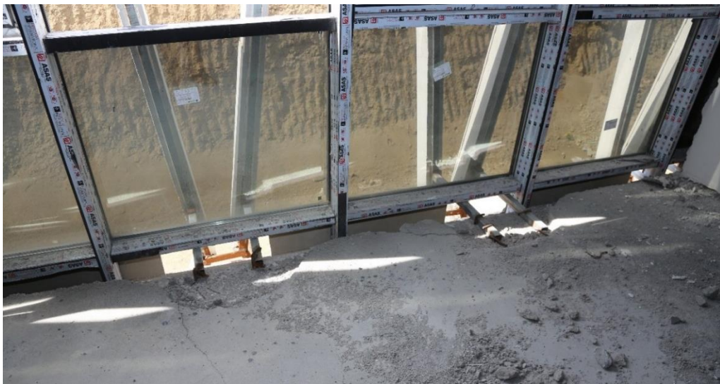
Şekil 4.2. Atölye binası-alüminyum giydirme cepheyle bina döşemesi arasındaki boşluklar.
