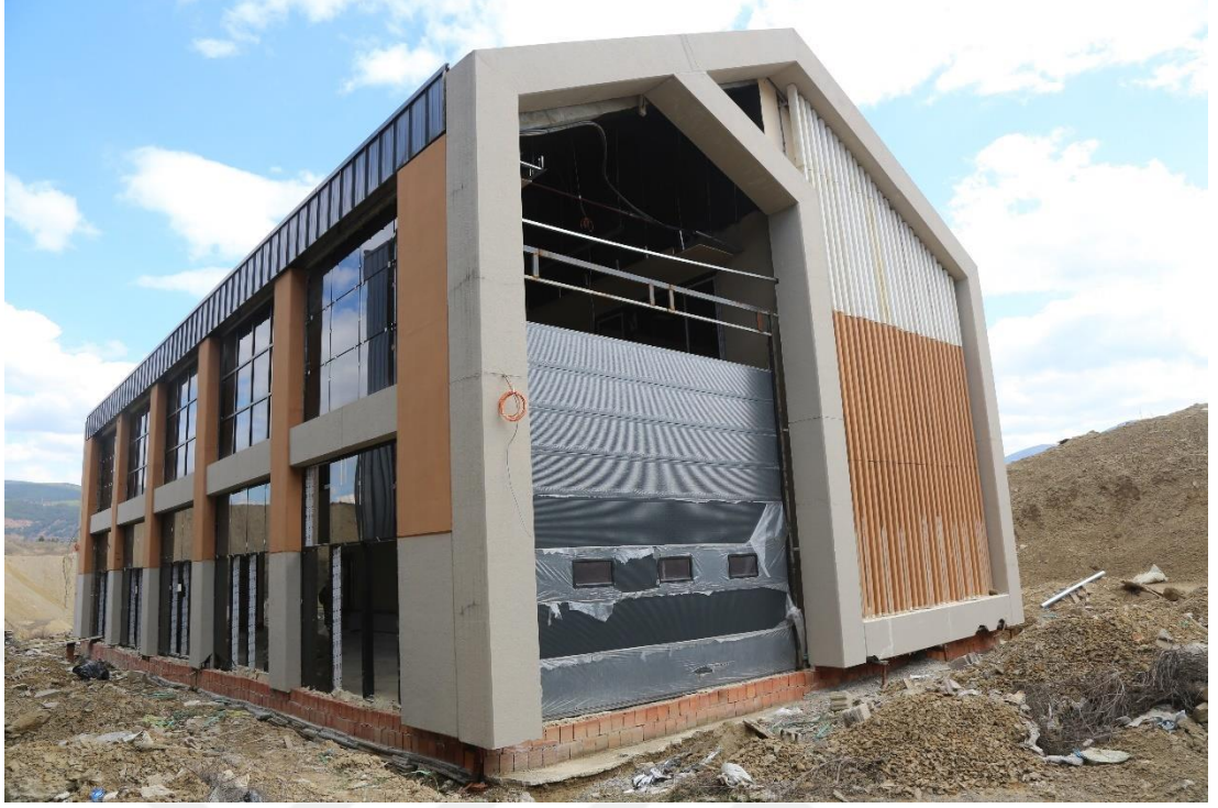
Şekil 3.17. Fesih sonrası garaj binası arka cephesinin durumu.
