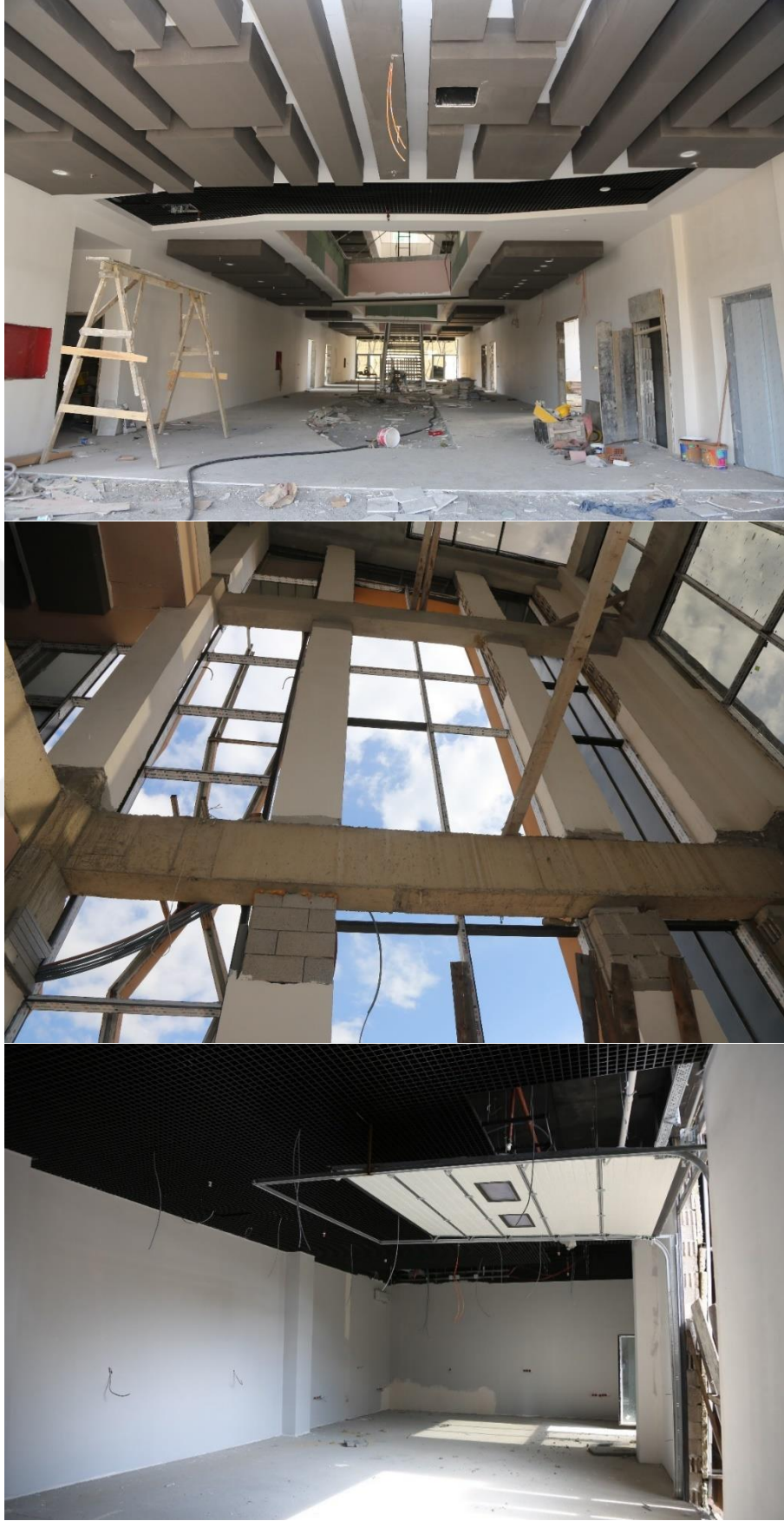
Şekil 3.15. Fesih sonrası atölye binası iç imalatlarının durumu.
