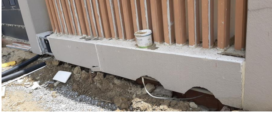
Şekil 3.25. İlk yüklenici tarafından kırık bırakılan prekast cephe imalatlarından görünüm.
