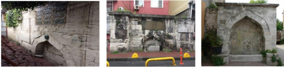
Şekil 3.6: İmar operasyonları sonucu hasar gören çeşmeler (Gündüz, 2020).
