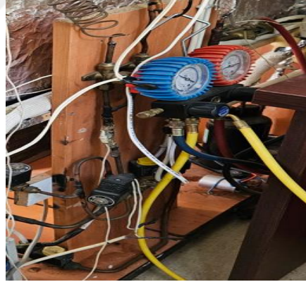
Şekil 4.7 Sistemde kullanılan soğutucu bağlantıları
