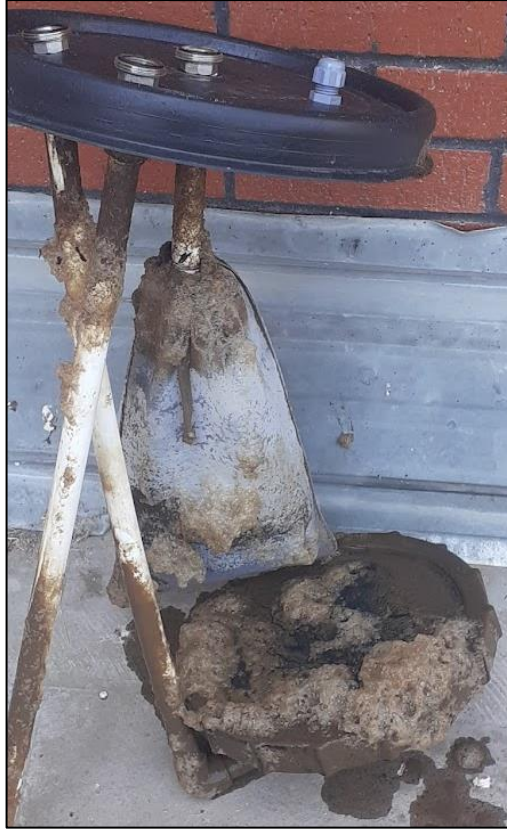
Şekil 3.33. Deneme sonrası kapak ve difüzörde oluşan kalıntılar
