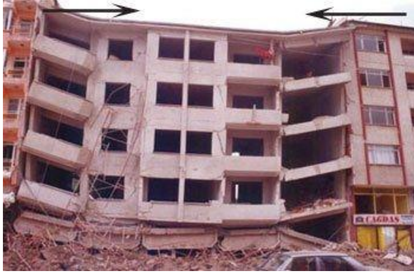
Şekil 3. 27. Çekiçleme etkisinde yıkılmış bir bina (I) (Anonim, 2009c)
