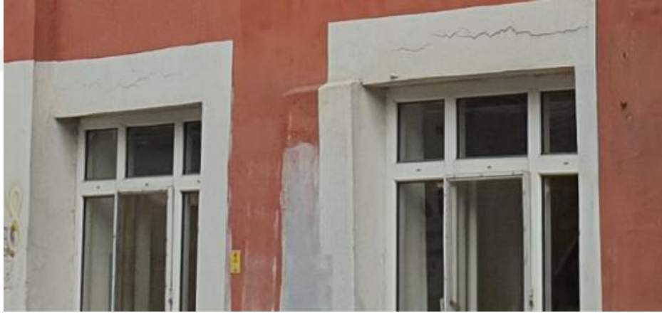
Şekil 3. 43. Duvar lento ayrılma çatlağına örnek (İlki vd., 2020)
