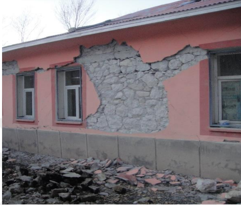
Şekil 3. 59. Yığma yapının taşıyıcı duvarında meydana gelen harç dökülmesi (İlki vd., 2020)
