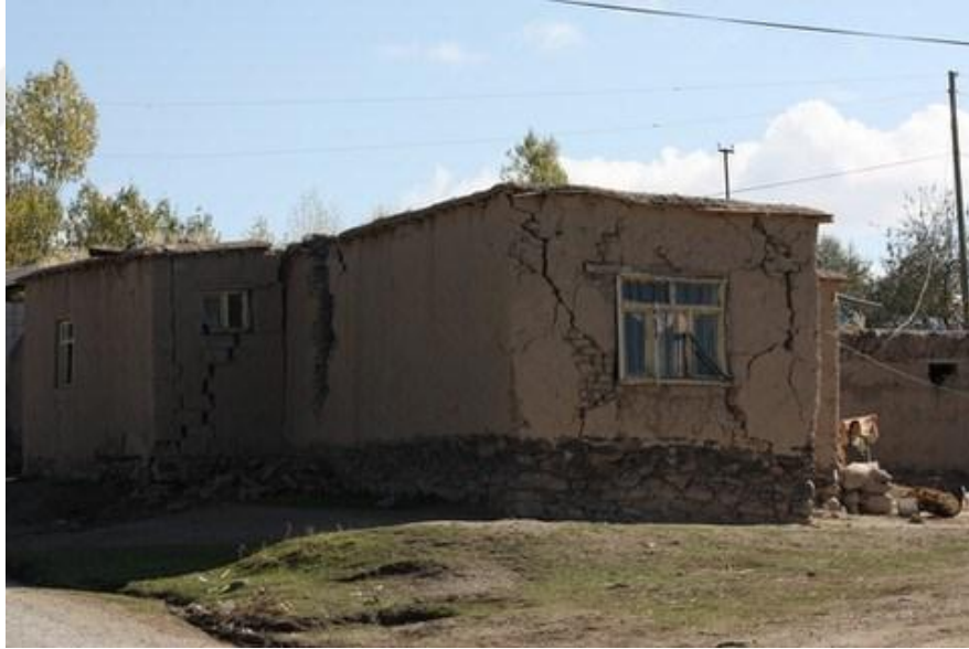
Şekil 3. 36. Van-Döşeme Mezrası'nda hasar almış yığma yapı (Parsa, 2012)
