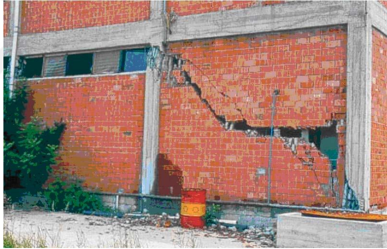
Şekil 3. 19. Kısa kolon hasarına örnek (Mutlu, 2007)
