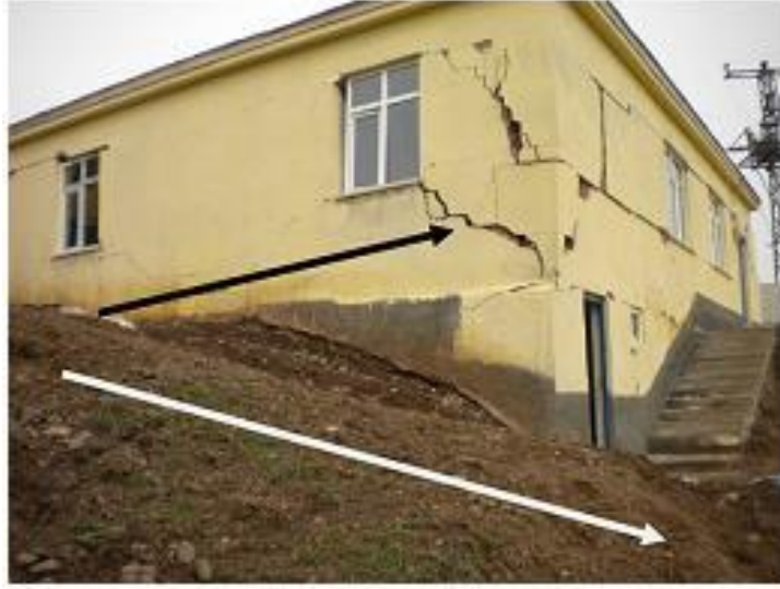
Şekil 5. 12. Temeldeki farklı oturmalardan kaynaklı hasar alan yığma yapı örneği (İlki ve Celep, 2011)
