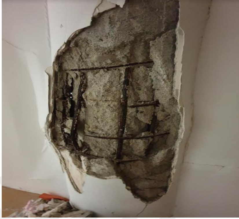
Şekil 3. 47. Yetersiz aderans ve donatı korozyonuna uğramış yapısal eleman ( İlki vd., 2020 )
