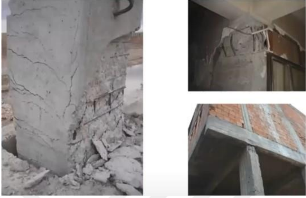
Şekil 3. 1. Eğilme kapasitesi hasarları (İlki vd., 2015)
