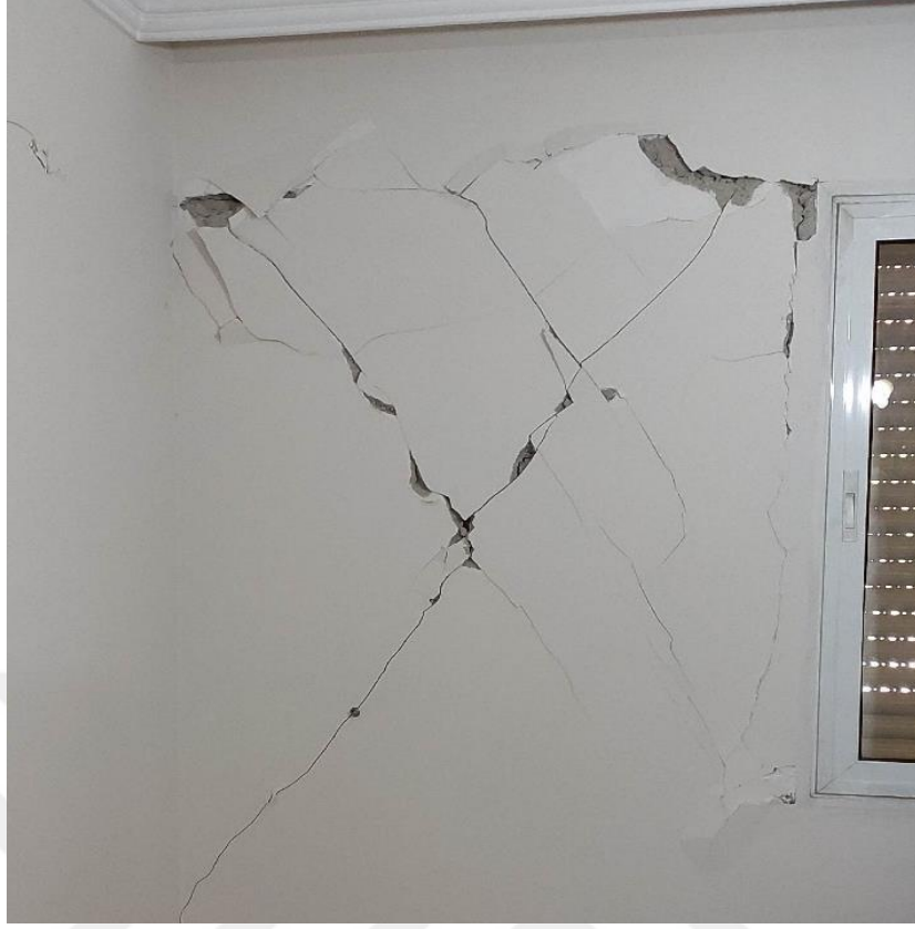
Şekil 3. 39. Deprem sırasında oluşan orta dereceli dolgu duvar hasarı ( Gültekin, 2022 )
