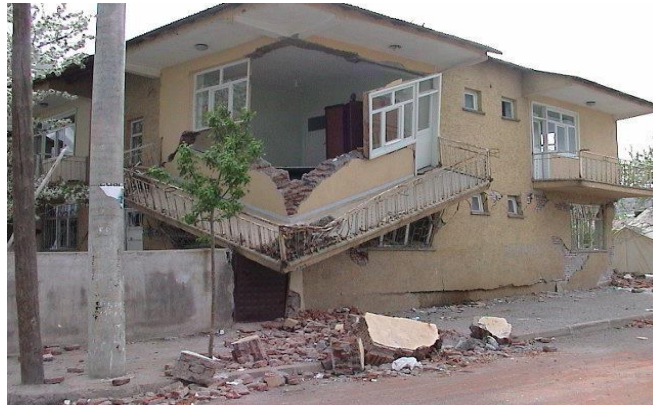
Şekil 3. 61. Yığma yapının taşıyıcı duvarında oluşan D tipi hasar (İlki vd., 2020)
