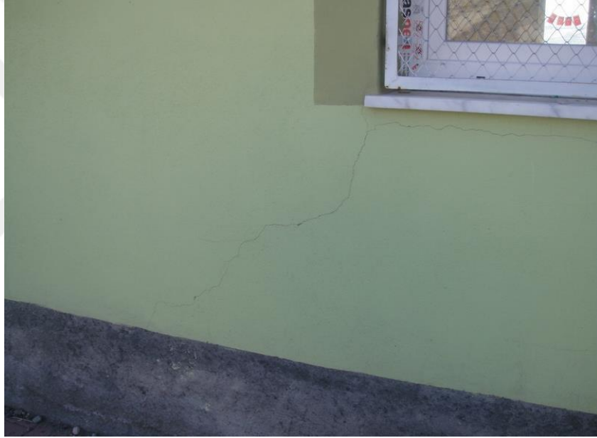
Şekil 3. 58. Pencere köşesinde meydana gelen sıva düzeyinde çatlak ( İlki vd., 2020 )
