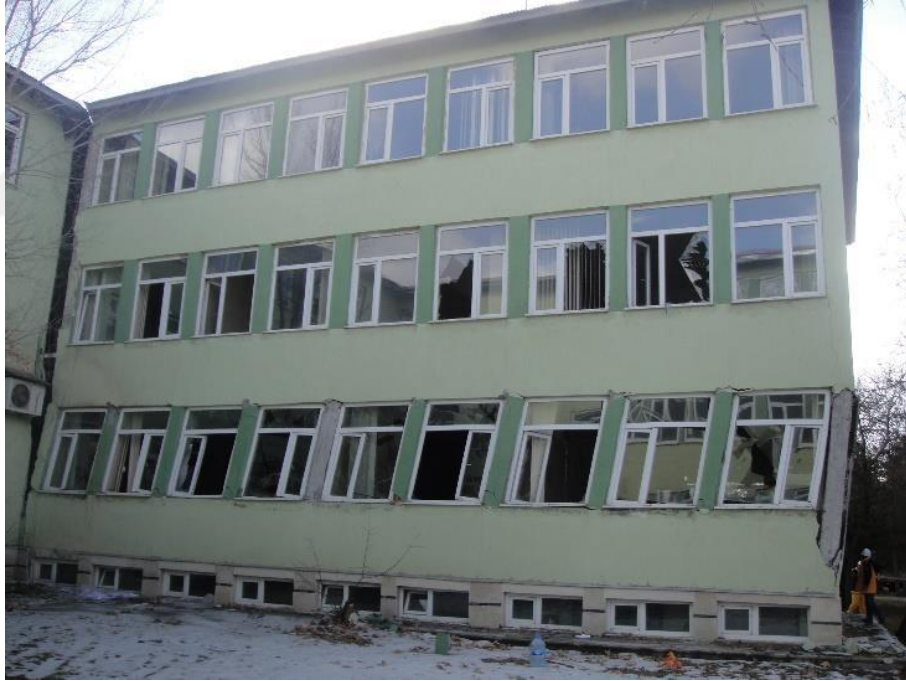
Şekil 5. 4. Katlar arası deplasmanın 0,02'den fazla olduğu betonarme yapı örneği (İlki vd., 2020)
