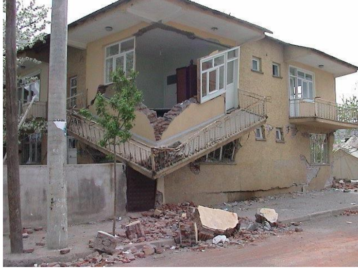
Şekil 5. 10. Bölgesel göçme durumuna örnek yığma yapı (İlki vd., 2020)
