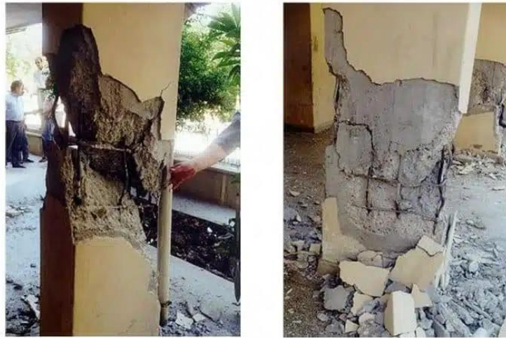
Şekil 3. 34. Kesme kapasitesinin yetersizliđinden kaynaklı kesme hasarı (Anonim, 2023a)
