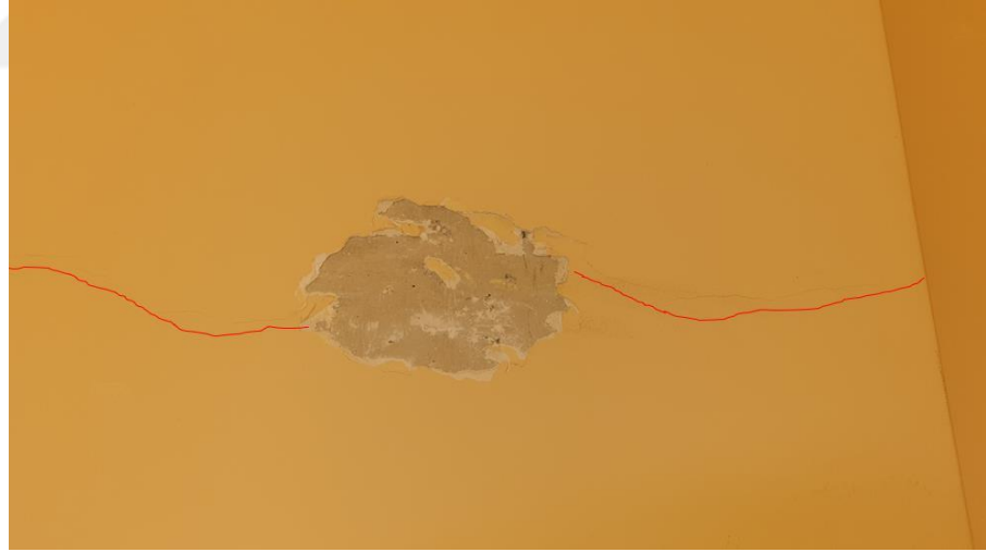
Şekil 3. 49. Sıva ve boya altında devam etmeyen çatlak örneği (İlki vd., 2020)
