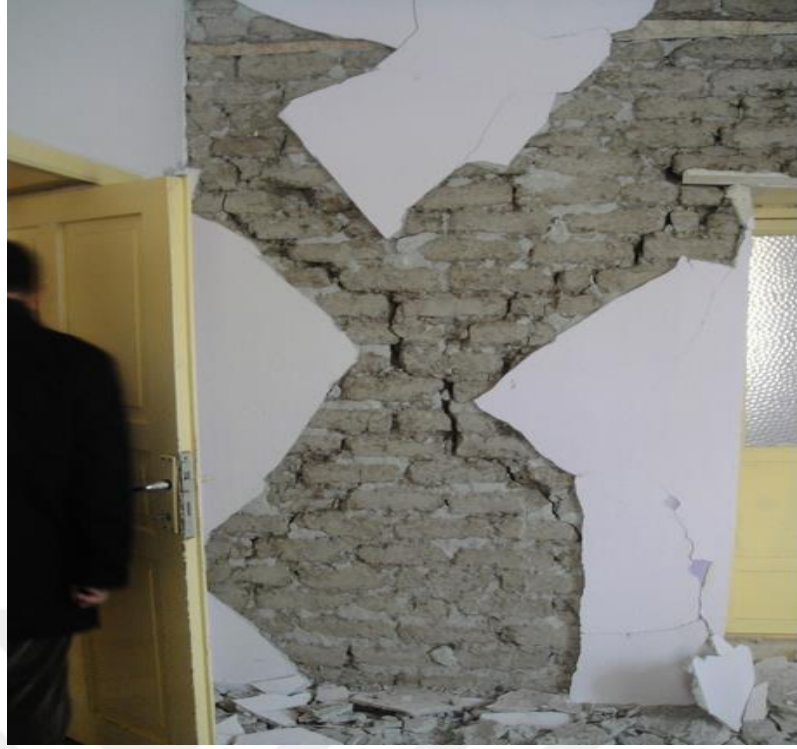
Şekil 3. 60. Yığma yapının taşıyıcı duvarında oluşan çatlak ve blok ezilmesi (İlki vd., 2020)
