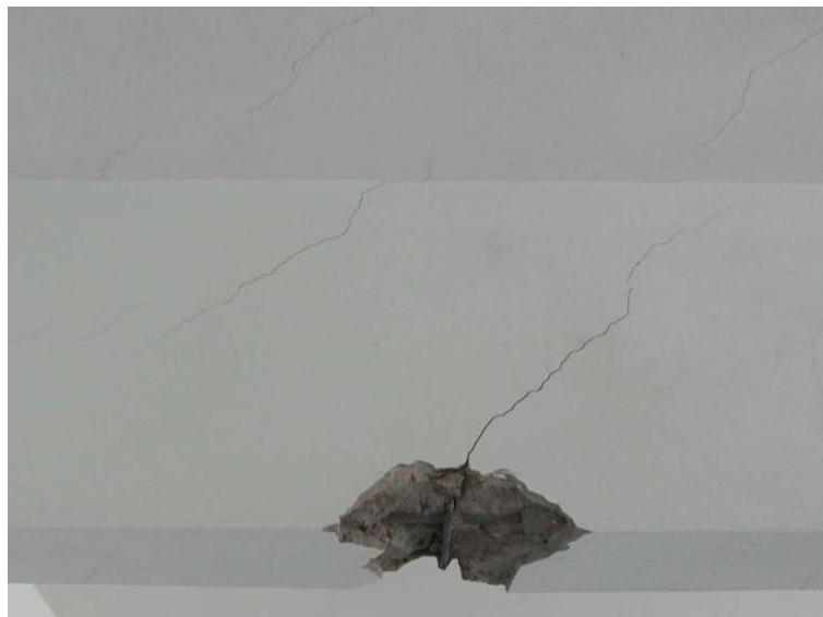
Şekil 3. 4. Kirişte kesme çatlağı (Sözen, 2003)
