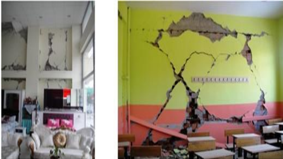
Şekil 3. 37. Bölme duvarı hasarına örnek (ilki vd., 2015)
