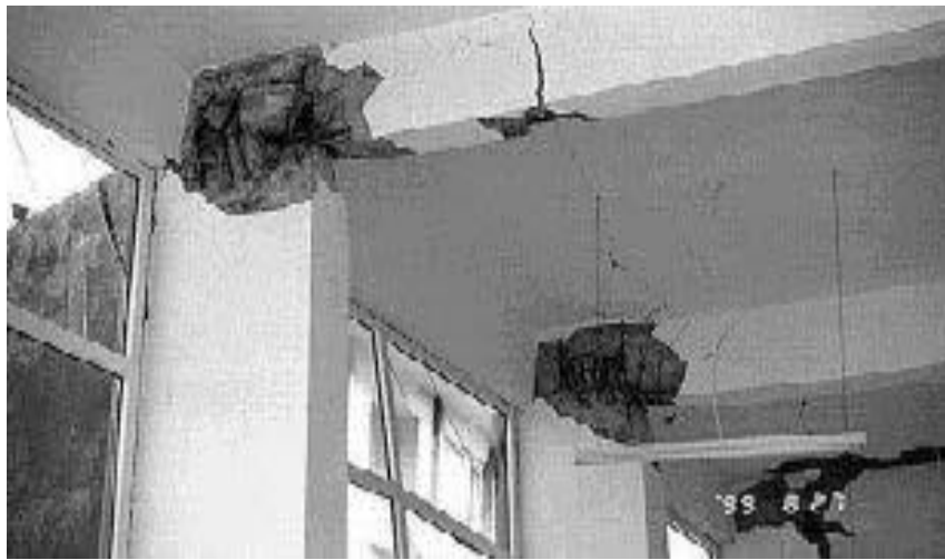
Şekil 3. 2. Düğüm noktasında mafsallaşma ve kirişte eğilme çatlağı (Sezen vd., 2003)
