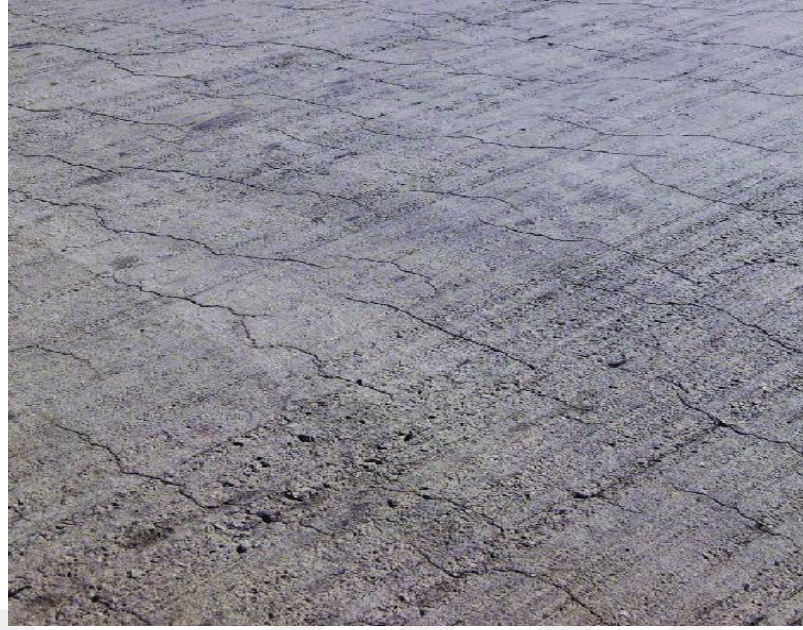
Şekil 3. 46. Rötre çatlağı örneği II (İlki vd., 2020)
