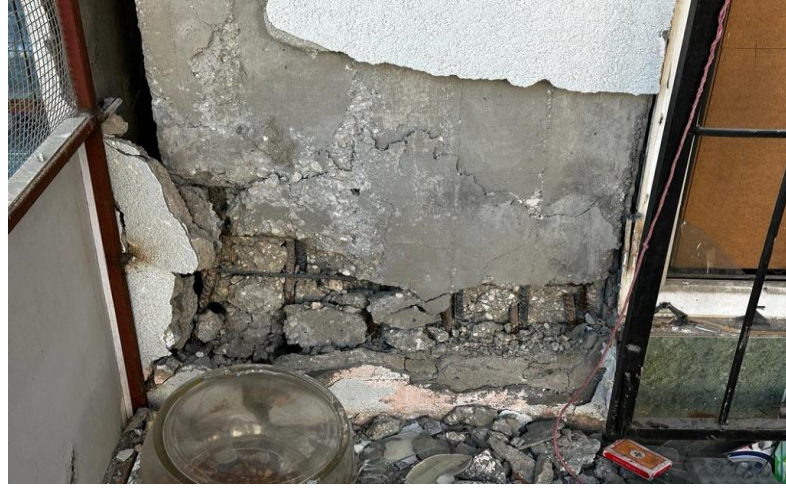
Şekil 3. 6. Betonarme yapıda yapısal hasar (6 Şubat 2023 Maraş Depreminden)
