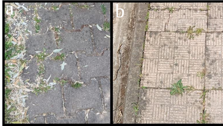
Şekil 3.17. İstiklal Anaokulu Sert Zemin Döşemelerinin Hasarları (a: yürüme yolu döşemesi- kilit parke taşı, b: okul çevresi bazalt döşeme) (Orijinal, 2024).
