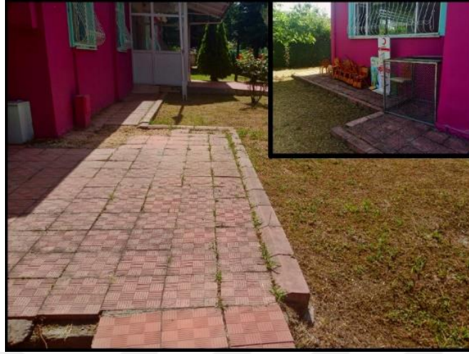
Şekil 3.35. Sevgi Anaokulunun Sert Zemin Döşemelerinin Hasarları (Orijinal, 2024)
