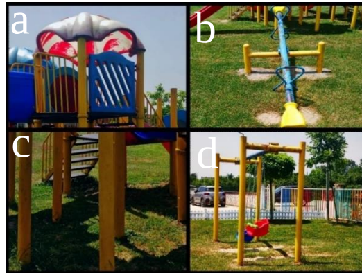
Şekil 3.23. Körpeşler Anaokulu Hasarlı Oyun Elemanları (a: kule çatısı, b: tahterevalli, c: oyun parkı iskeleti, d: salıncak) (Orijinal, 2024).
