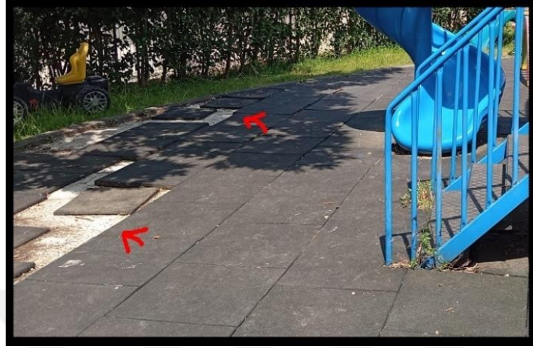
Şekil 3.16. İstiklal Anaokulu Oyun Alanı Zemin Döşemesi Hasarı (Orijinal, 2024).
