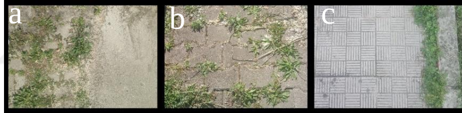
Şekil 3.25. Mevlüde Çıtlak Anaokulu Sert Zeminlerin Hasarları (a: geleneksel oyun alanı ve meydan birleşim noktası, b: yürüme yolu kilit parke döşeme, c: okul etki alanı bazalt döşeme) (Orijinal, 2024).
