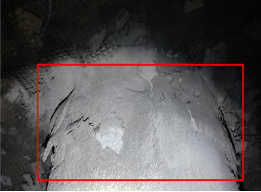
Şekil 5.11. MPBX 04 yakınındaki burkulmuş betonarme topuk
