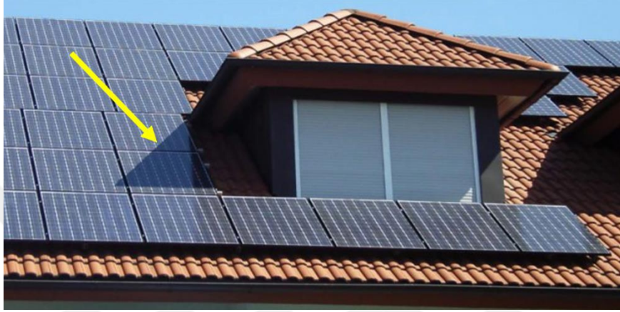
Şekil 2.10. FV paneller üzerine çatıdan kaynaklı gölge düşmesi durumu
