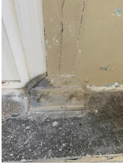
Şekil 4.42 Döşemeler ve taşıyıcı sistemde meydana gelen hasarlar [41]
