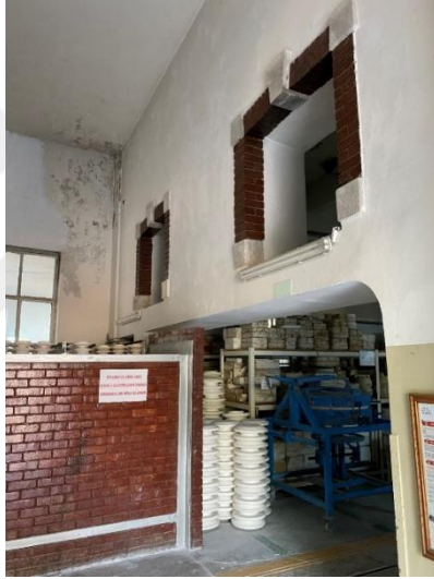
Şekil 4.40 Duvarlarda meydana gelen hasarlar [41]
