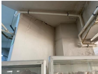
Şekil 4.41 Tavanlarda meydana gelen hasarlar [41]
