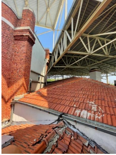
Şekil 4.39 Çatıda meydana gelen hasarlar [41]
