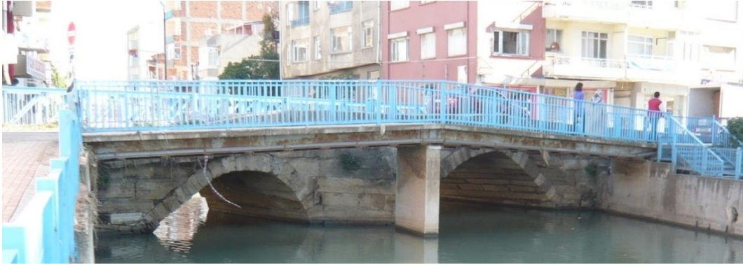
Şekil 4.4 Köprü kemeri, yükleme nedeniyle oluşan deformasyon sonucunda yük taşıma kapasitesini kaybetmiştir. Üzerindeki harçlı dolgunun yük aktarması sayesinde ayakta kalabilmektedir. Silivri Girişi Köprüsü (Kısa Köprü), İstanbul, Silivri. (Pınar Gök, 2009)
