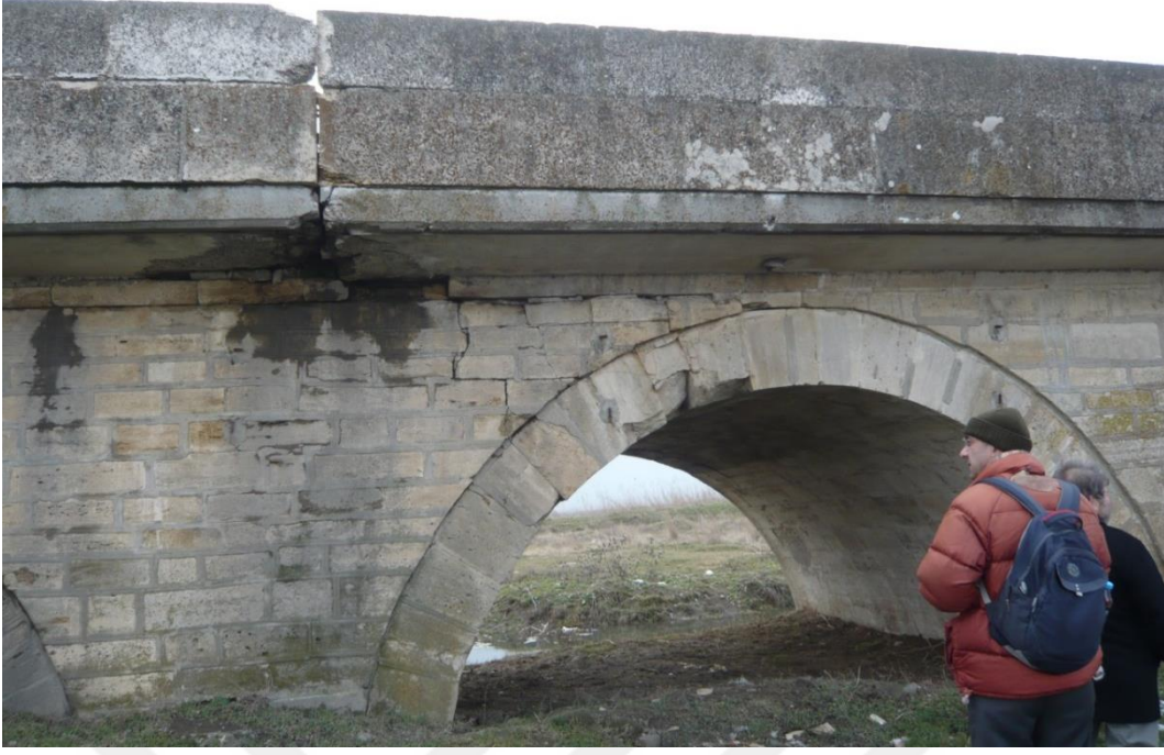
Şekil 4.13 Uzunköprü üzerindeki betonarme tabliyeden kaynaklı çatlak ve drenaj sorunları, Edirne, Uzunköprü (Pınar Gök, 2012).
