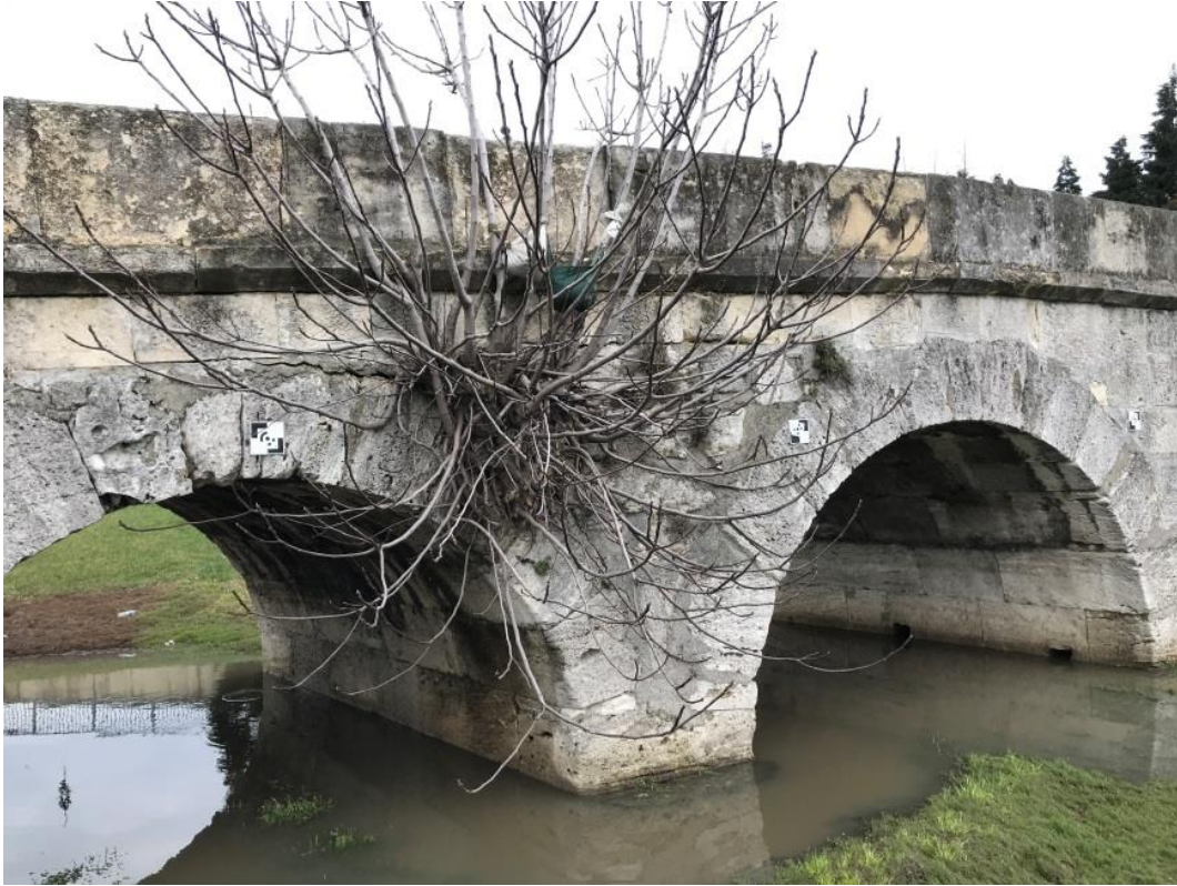
Şekil 4.35 Çobançeşme Köprüsü tempan duvarında incir ağacı, İstanbul, Küçükçekmece (Pınar Gök,2021).
