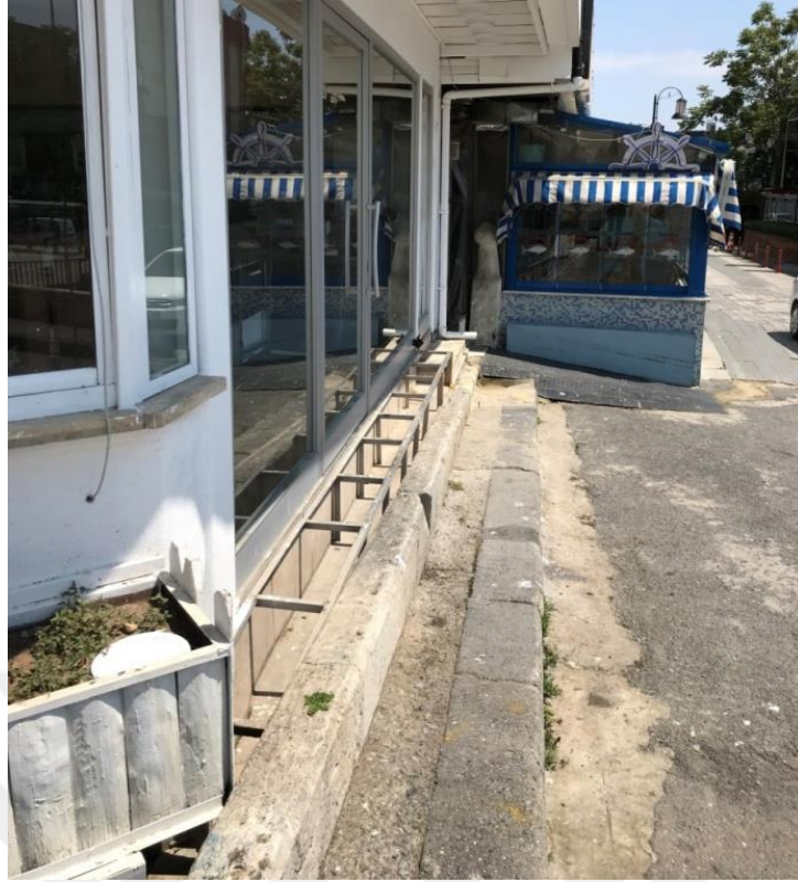
Şekil 4.19 Bostancı Köprüsü memba tarafına köprü korkuluklarına bitişik yapılan bina ve baba taşına bitişik, yola taşan muhdes ekler, İstanbul, Bostancı (Pınar Gök, 2020).
