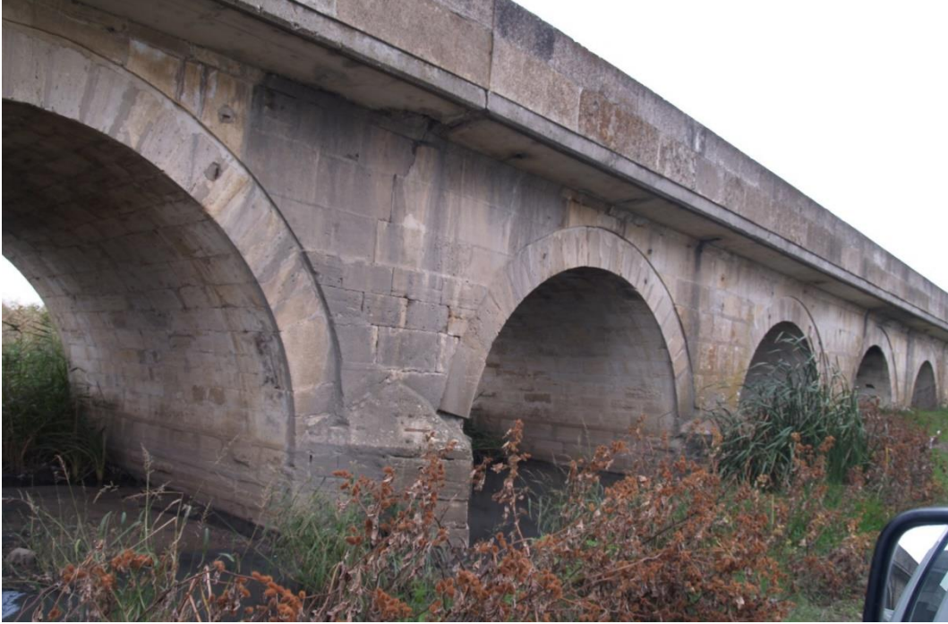
Şekil 4.14 Uzunköprü üzerindeki betonarme tabliyede dilatasyon ve garguylardan sızan suyun oluşturduğu yüzey kirliliği, Edirne, Uzunköprü (Pınar Gök, 2006).
