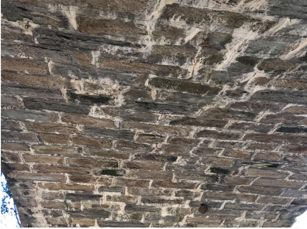
Şekil 4.33 Kısalar Köyü Köprüsü’nde dolgudaki kirecin suda çözünmesi, kemer karnında derzlerden sızarak sarkıtlar oluşturması, Kocaeli. (Pınar Gök, 2021)
