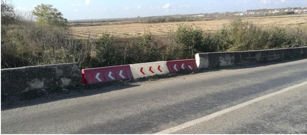
Şekil 4.7 Araç çarpması nedeniyle oluşmuş korkuluk hasarları. Pehlivanköy Köprüsü, Kırklareli, Pehlivanköy (Pınar Gök, 2019)
