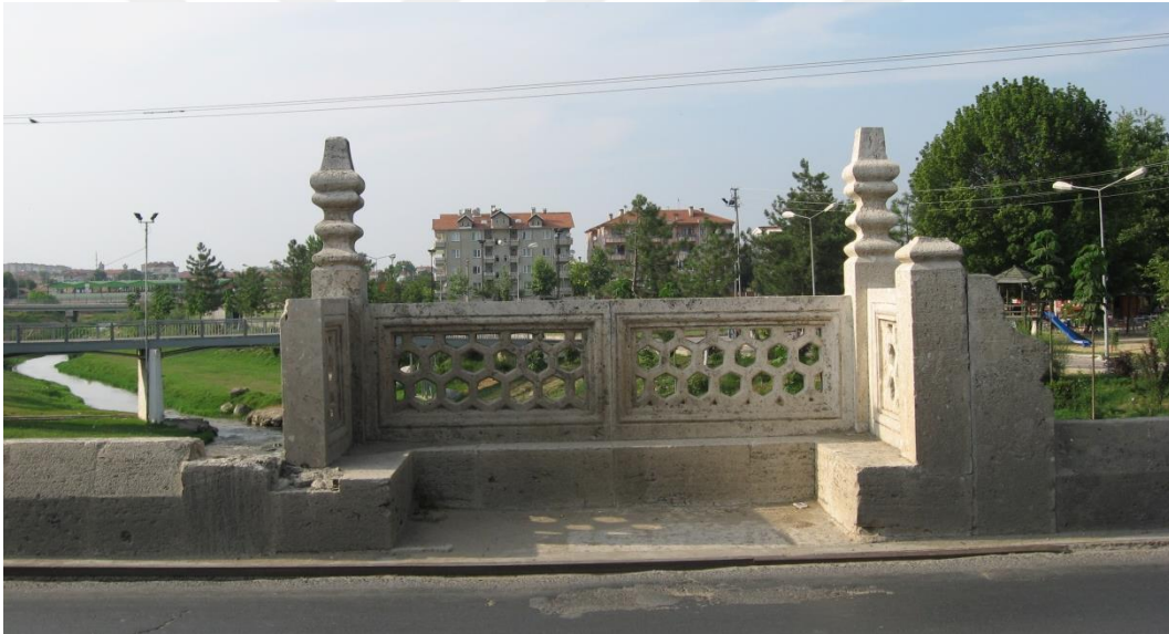
Şekil 4.6 Araç çarpması nedeniyle oluşmuş baba taşı ve korkuluk hasarları. Babaeski Köprüsü, Kırklareli, Babaeski (Pınar Gök, 2008).
