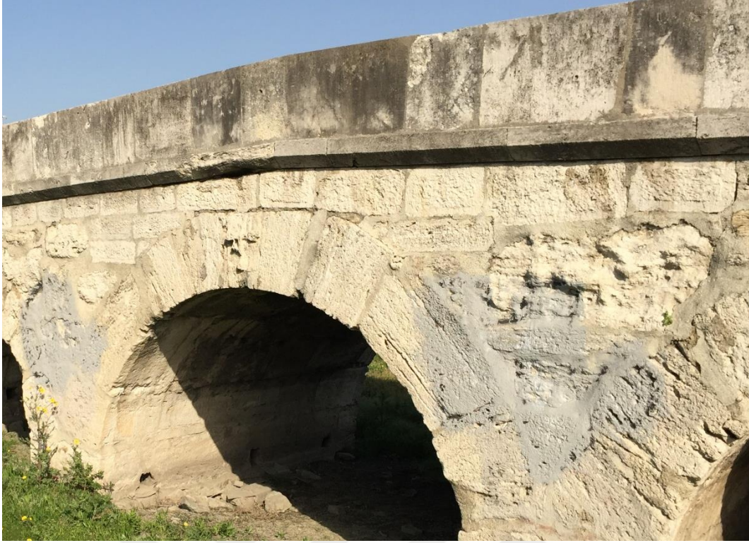
Şekil 4.8 Çobançeşme Köprüsü’nde çimentolu harçla yapılmış derz dolguları. İstanbul, Küçükçekmece (Pınar Gök, 2016).
