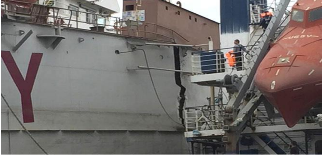
Şekil 3.7 Yüzer havuzun kırıldığı bölge (Denizcilik Dergisi, 2019)
