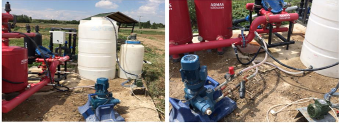
Şekil 3.12 Dozaj pompası ile gübreleme işlemi
