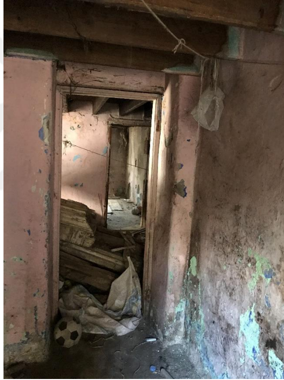
Şekil 15 İnsan Kaynaklı Deformasyonlar (İstanbul Büyükçekmece 329 ada 6 parsel) (Süleyman, 2020).
