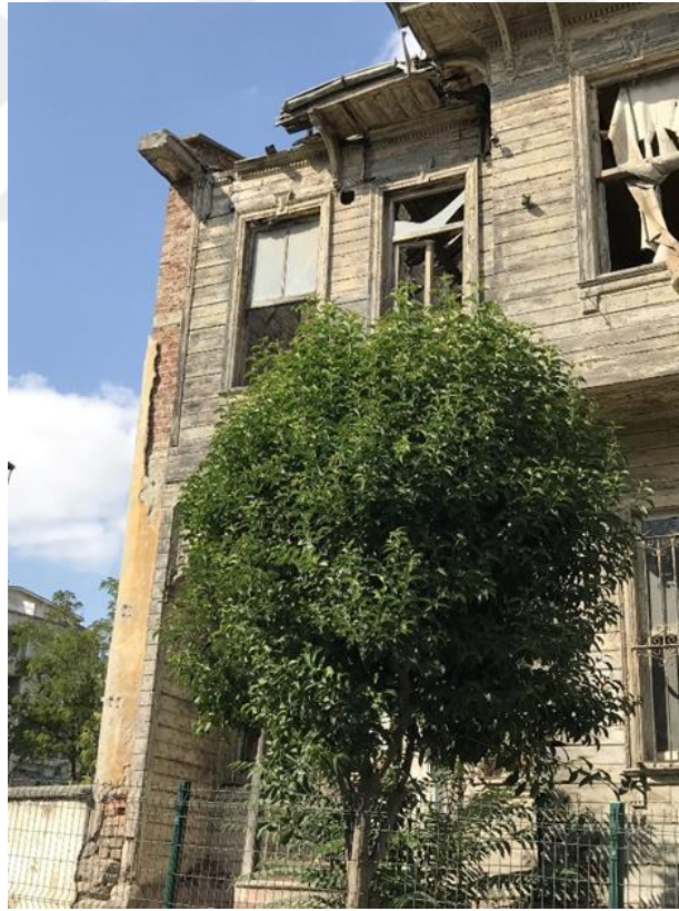
Şekil 14 Dış Etkenlere Bağlı Deformasyon (İstanbul-Büyükdere 329 Ada 6 Parsel) (Süleyman, 2020).
