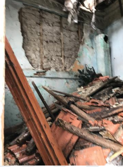
Şekil 26 Düşey ve yatay taşıyıcı tahribatları (İstanbul-Büyükçekmece 329 Ada 6 Parsel) (Süleyman, 2020).
