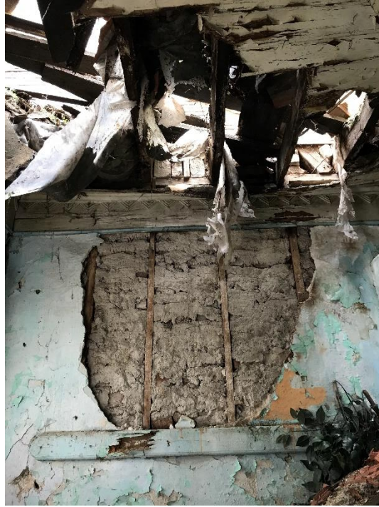
Fotoğraf 23 İstanbul-Büyükçekmece 329 Ada 6 Parsel Hasarlı Kısım Görünümü
