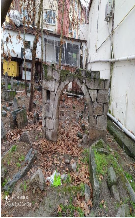
Görsel 3. Türbe Duvarı Genel Görüntü.
