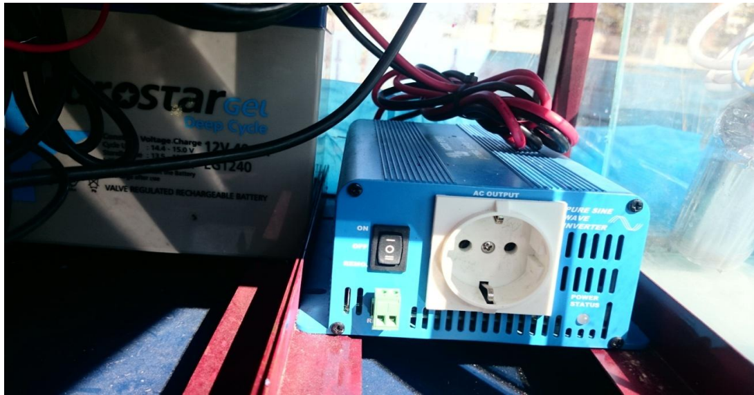
Şekil 2.28. Montajı yapılmış invörtör
