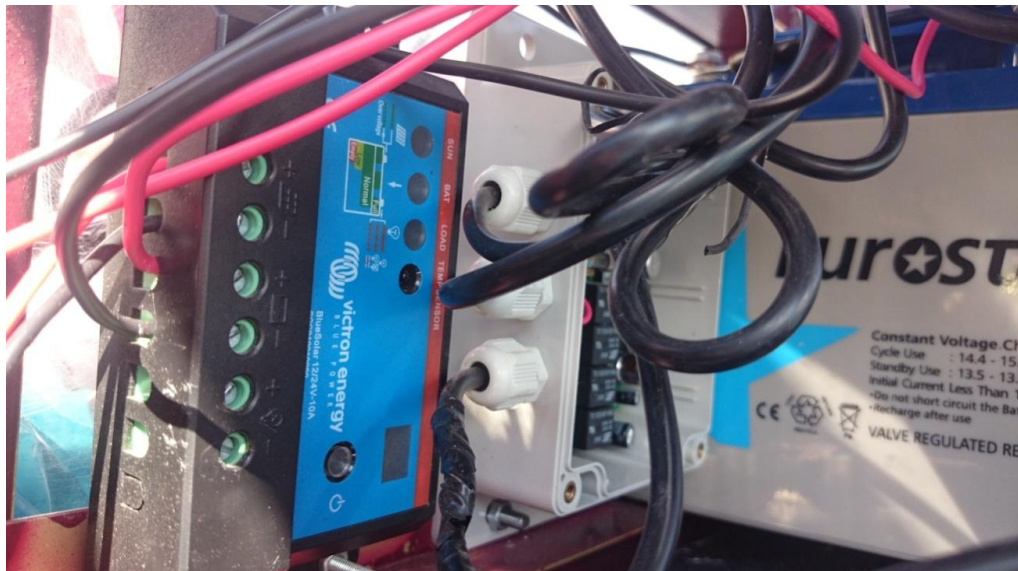
Şekil 2.24. Montajı yapılmış şarj kontrol cihazı
