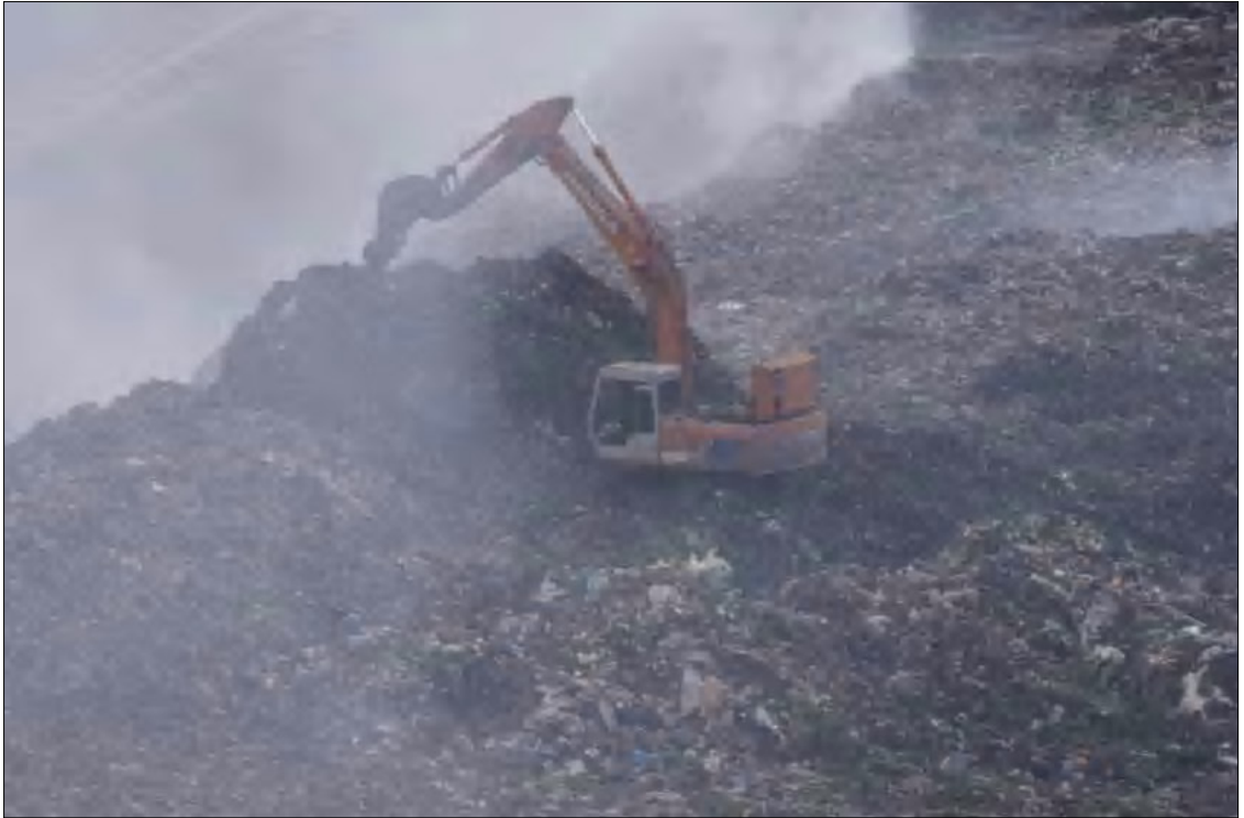
Şekil 7-1. Rehabilitasyon öncesi Molu çöp depolama sahasına ait görüntüler
