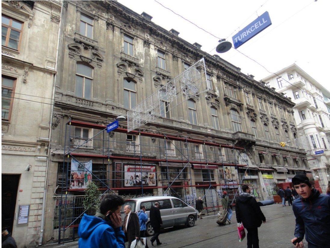
Şekil 5.45 : Cercle d'Orient binası yıkılmadan kısa süre önceki durumu.
