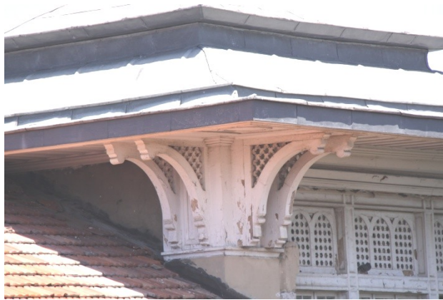
Şekil 5.247 : Tıbbiye binası pencereler ve konsol içlerinde kafesli bezeme.
