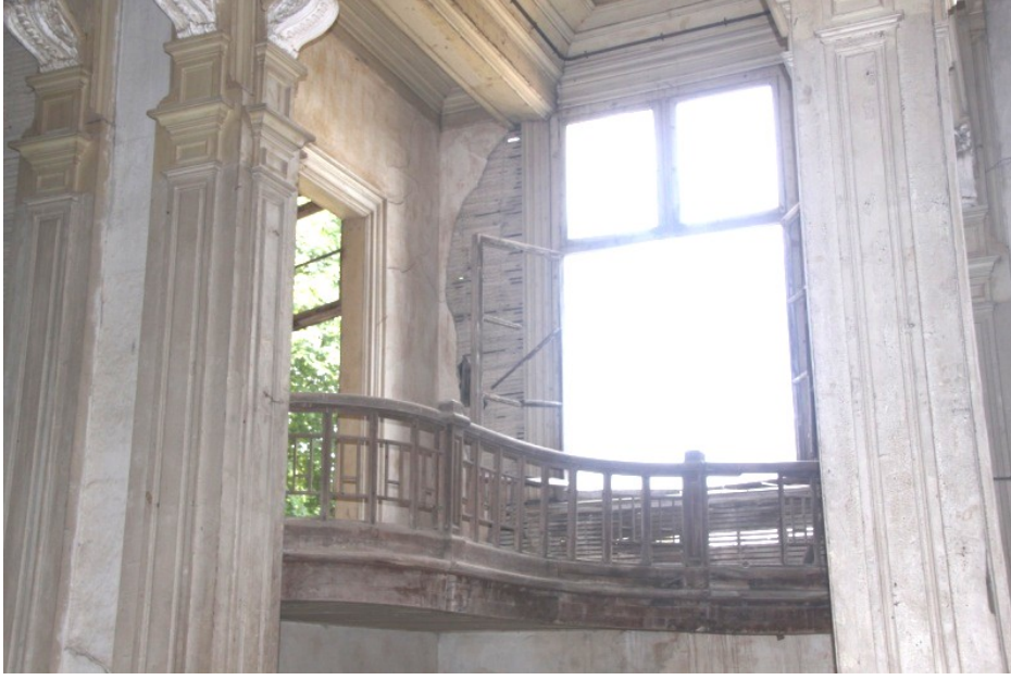
Şekil 5.206 : Prinkipo Palas tiyatrosundaki ahşap balkon korkulukları.
