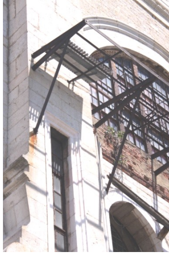
Şekil 5.243 : Tıbbiye deniz cephesinde saçığa ait ince demir destekler.
