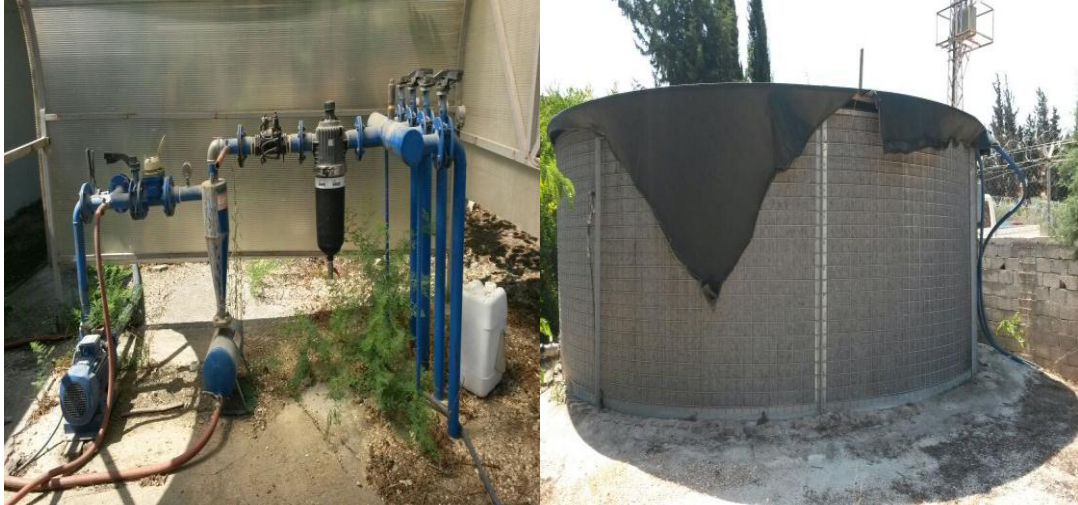
Şekil 3.3. Damla sulama sisteminin denetim birimleri (Elek filtre, hidrosiklon, su sayaçları ve manometreler)
