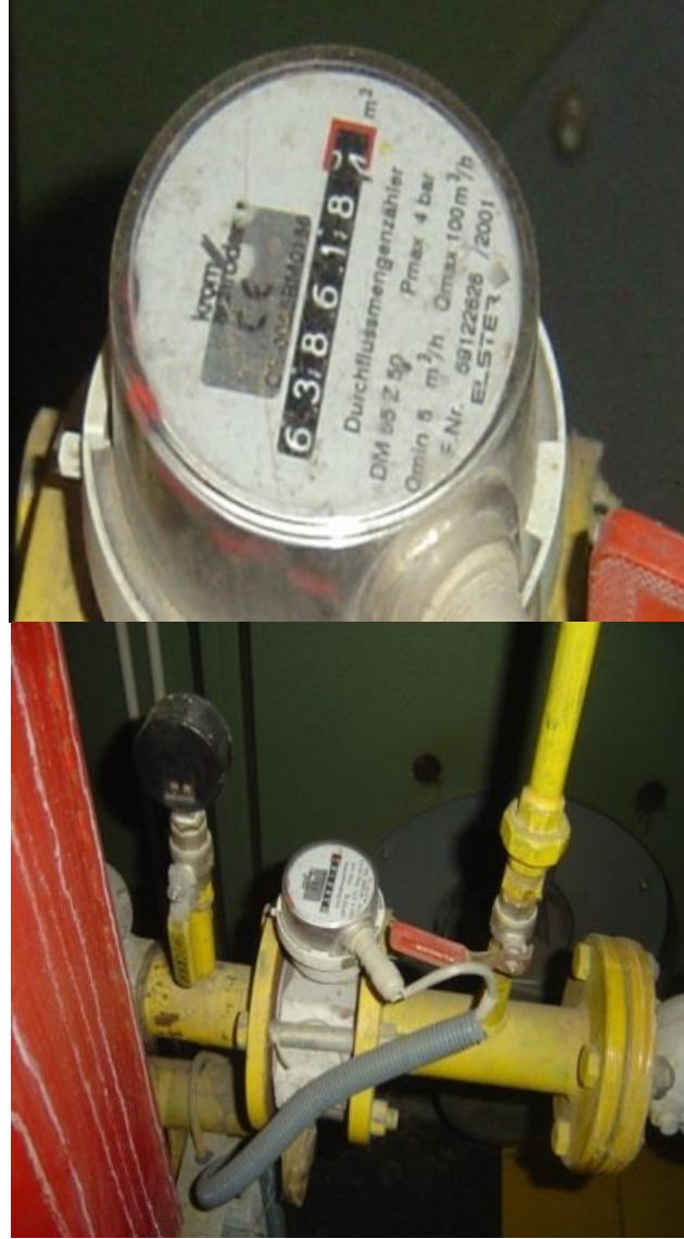
Şekil 2.11 Kurutma firmı enerji girdilerinin ölçüm noktası,doğal gaz sayacı
