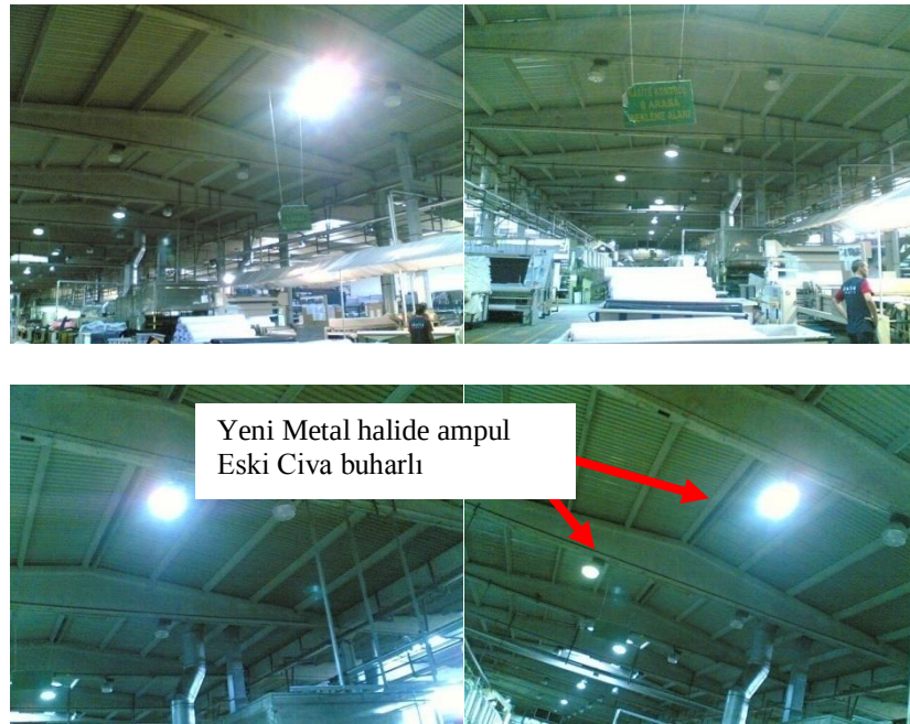
Şekil 2.22 Örnek bir fabrika metal halide ampul –Cıva buharlı uygulaması
